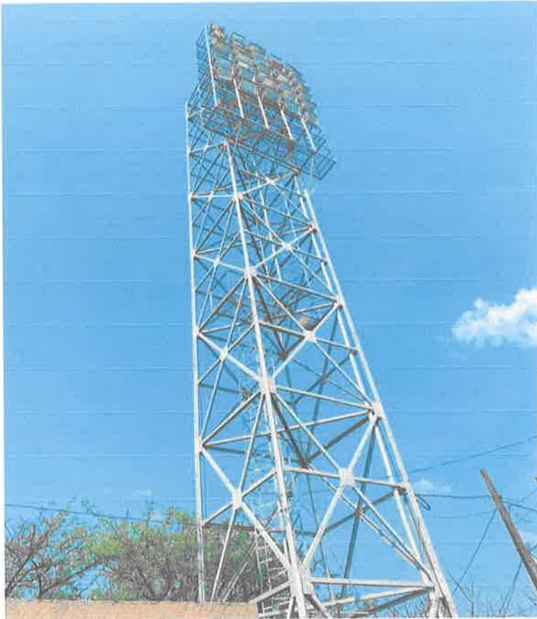
Torre de iluminação
