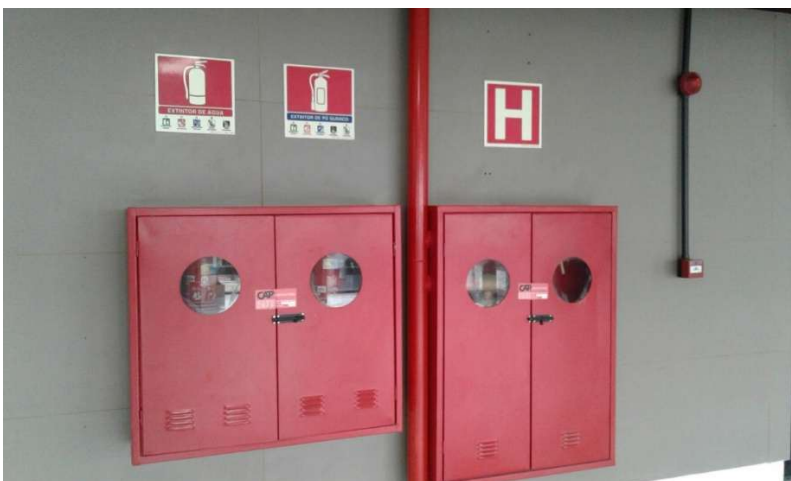
FOTO: Sistema de combate a incêndio
