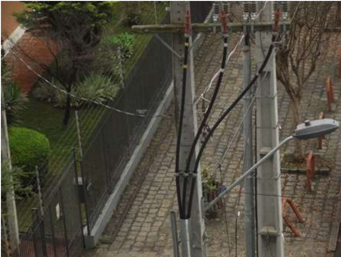
FOTO: Saídas dos cabos
