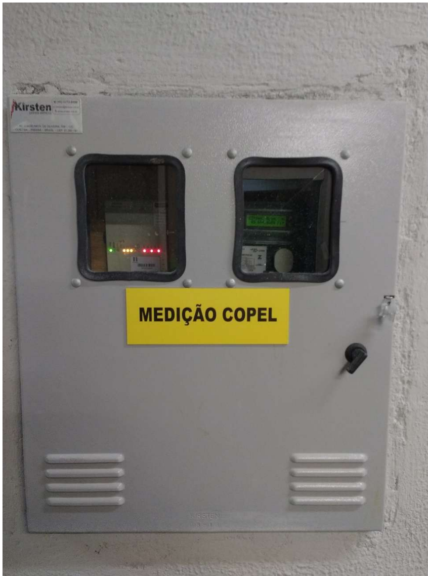
FOTO: Medidores de energia
