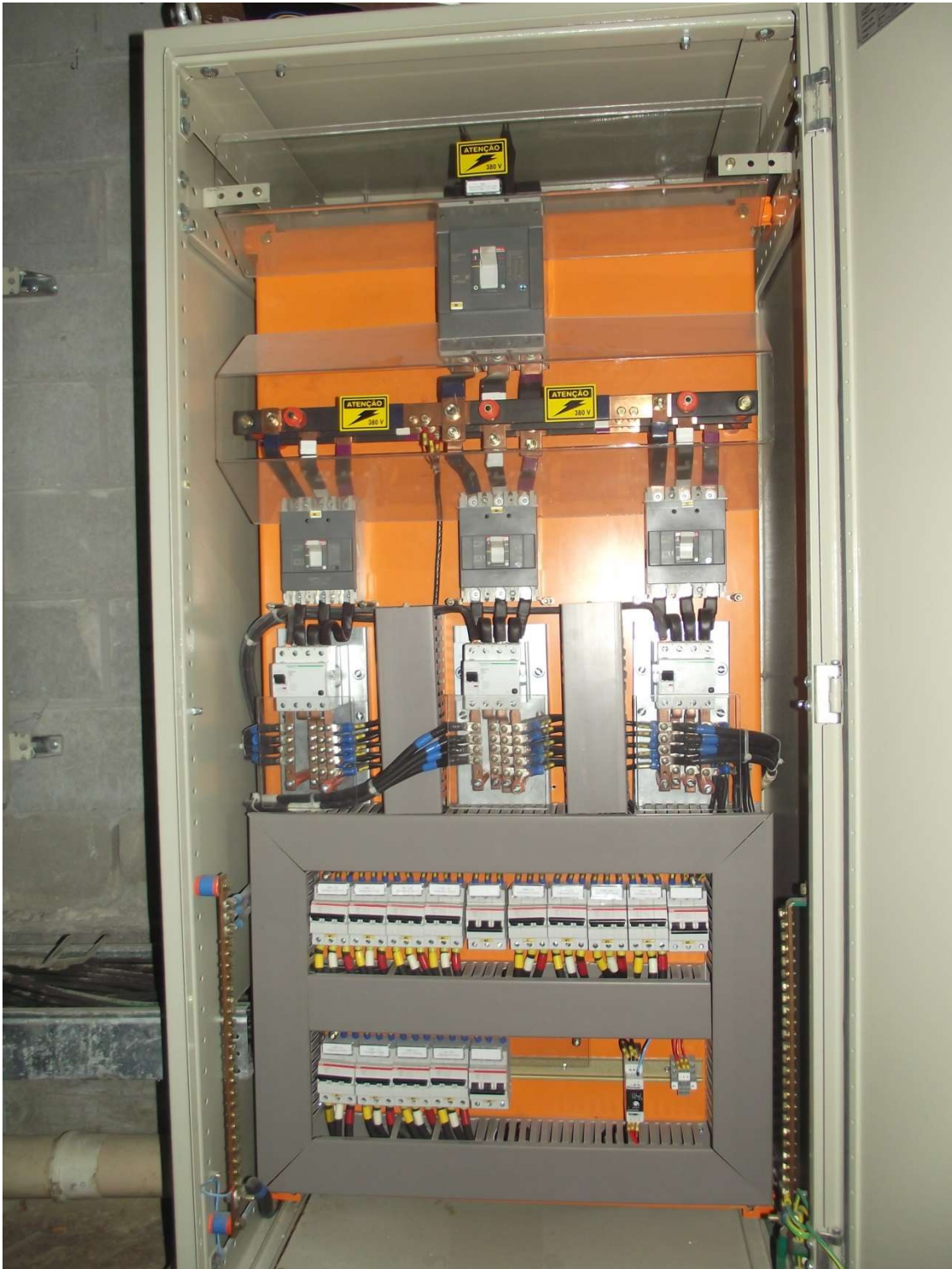
FOTO: Quadro de distribuição
