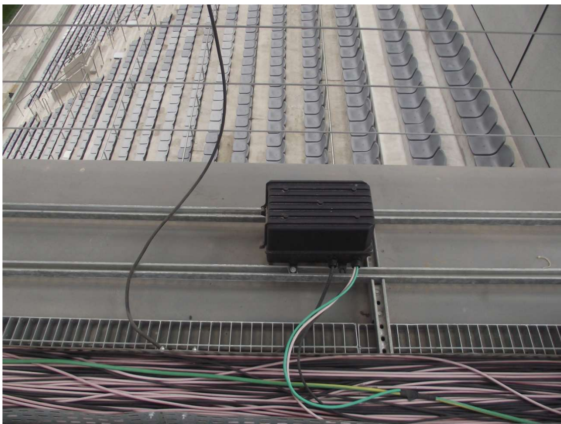
FOTO: Aterramento partes metálicas
