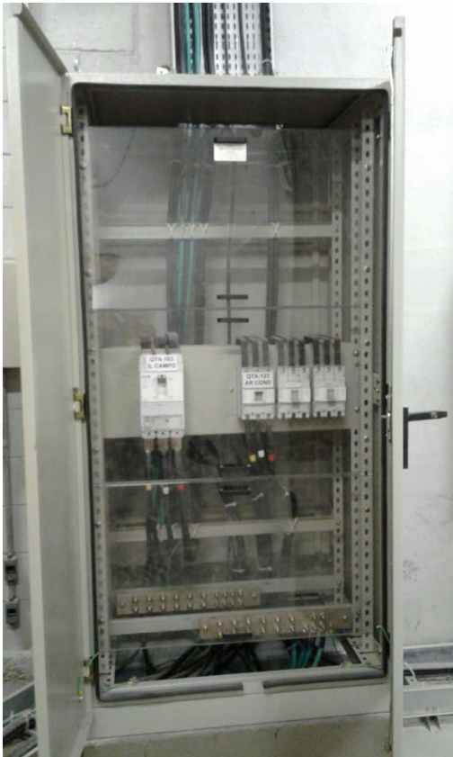
FOTO: Sistema de instalações elétricas
