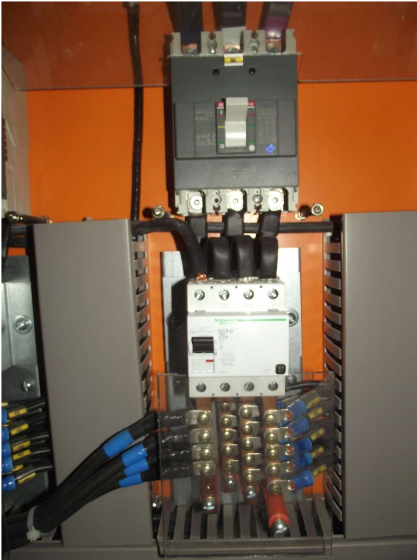
FOTO: Proteção contra sobre corrente
