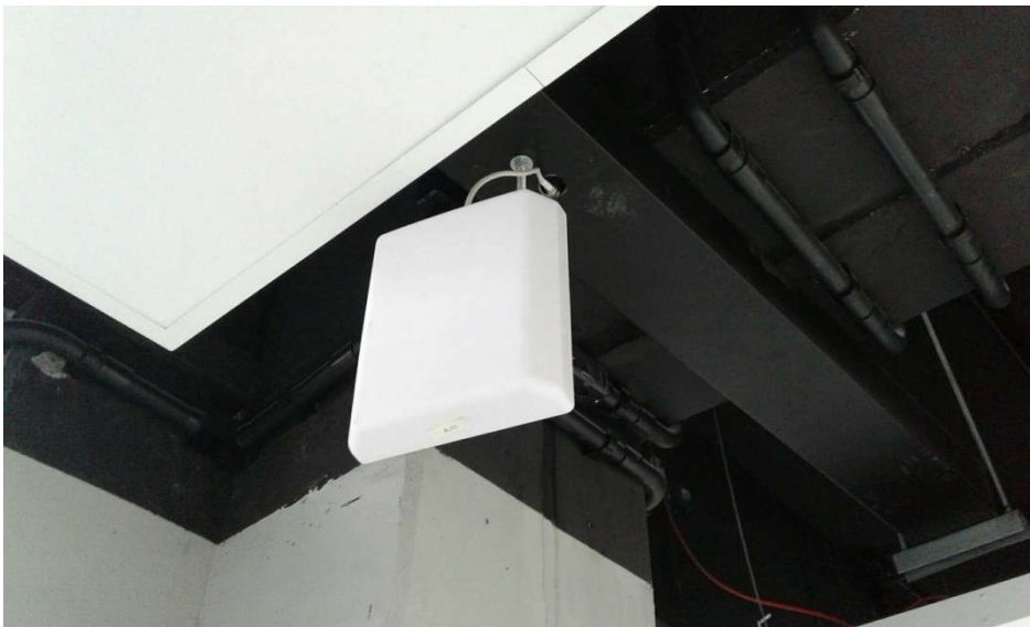
FOTO: Repetidora de sinal de telefonia
