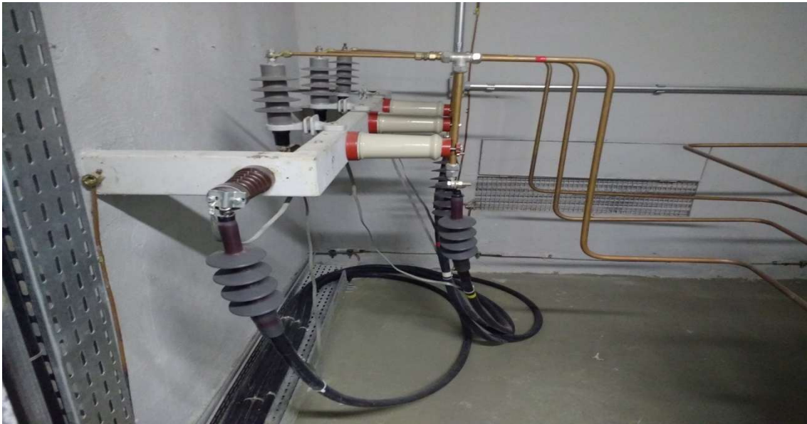
FOTO: Muflas e terminações
