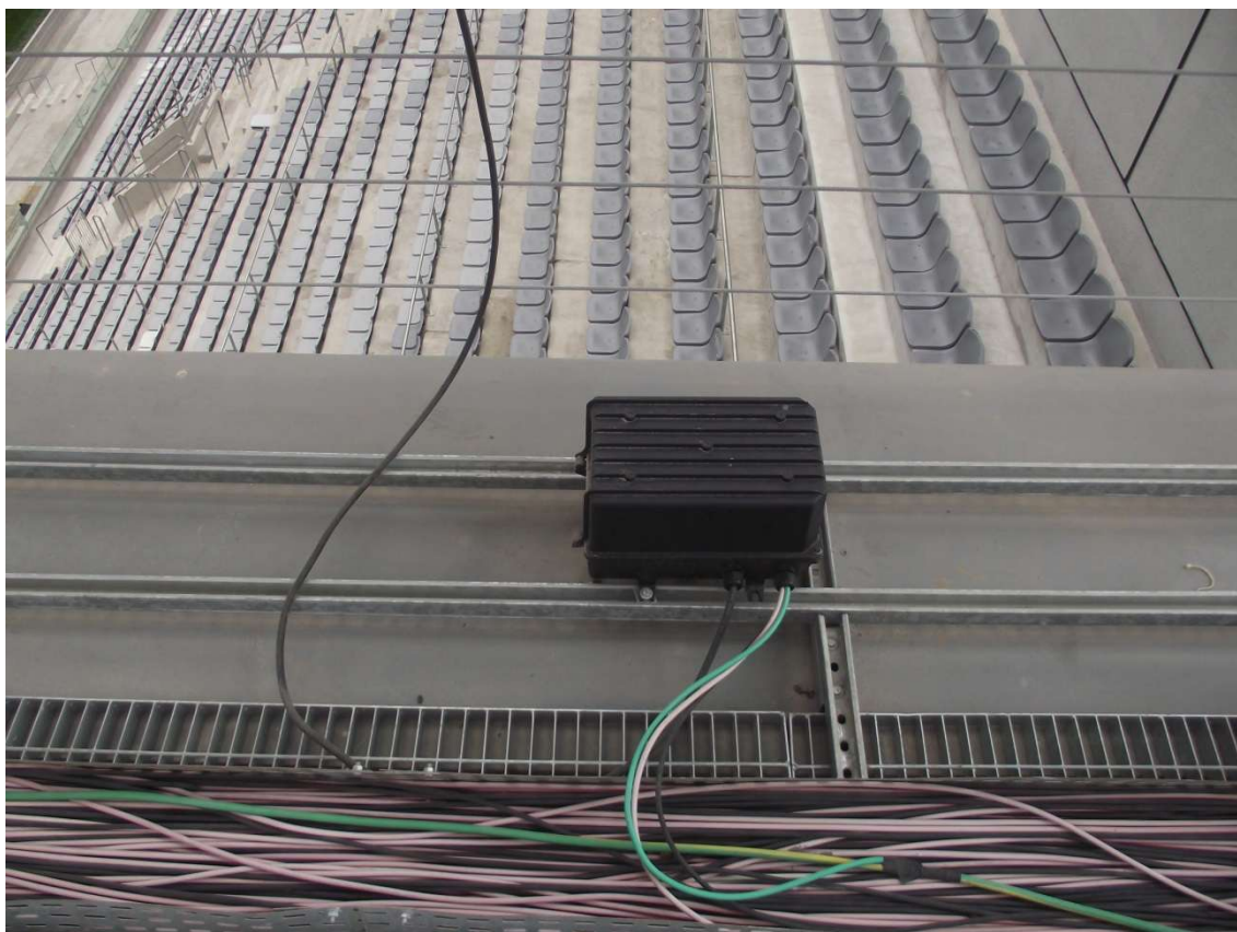
FOTO: Reator de iluminação do campo
