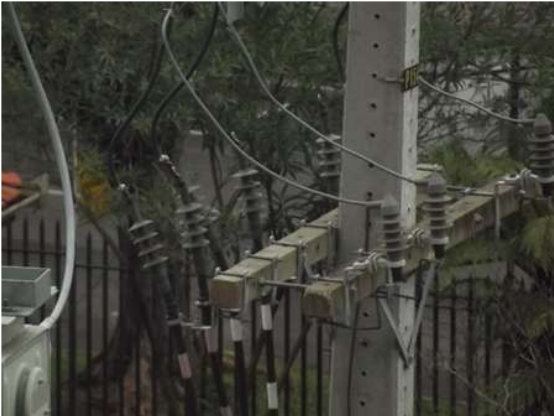
FOTO: Muflas e terminais
