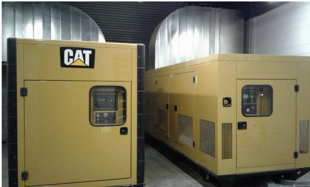
FOTOS: Sistema de geradores
