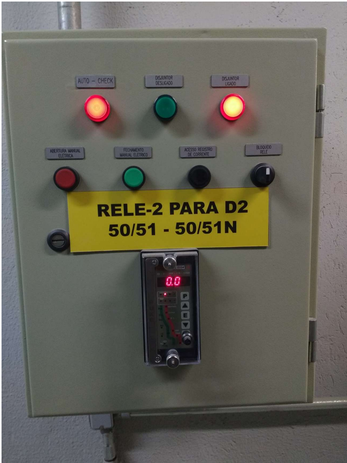
FOTO: Quadro subestação principal
