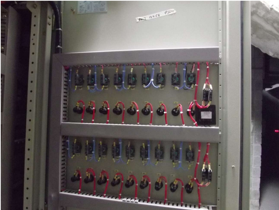
FOTO: Quadro elétrico acionamento iluminação campo
