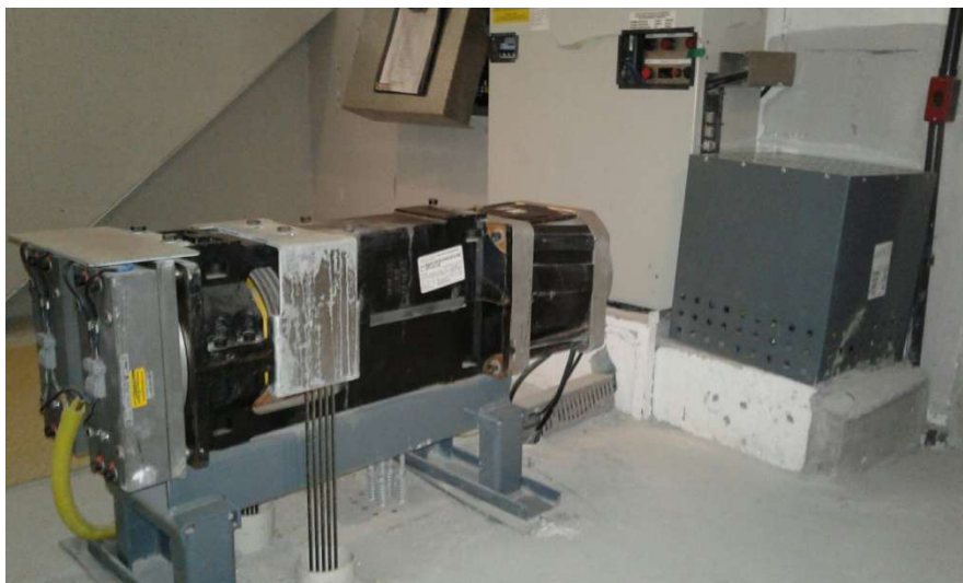
FOTO: Casa de máquinas do elevador 6
