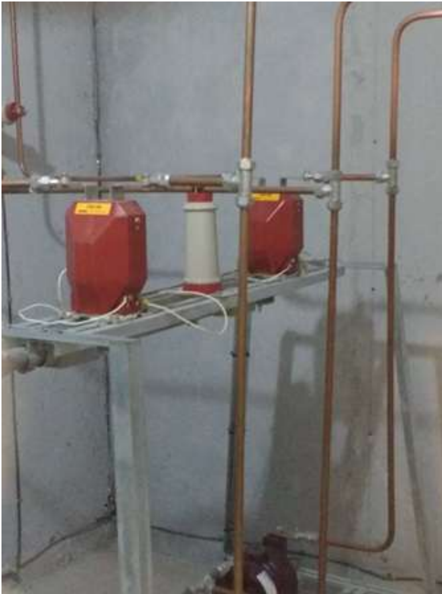
FOTO: Transformador para instrumentos
