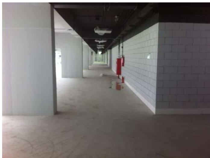
FOTO: Pintura dos corredores na cor cinza
