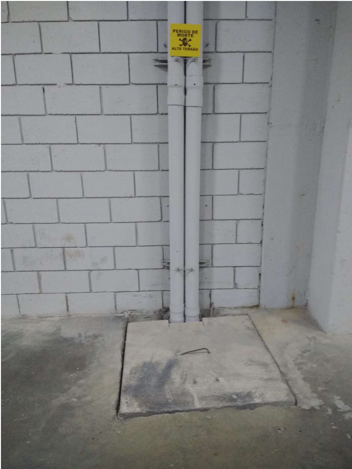
FOTO: Banco de eletrodutos
