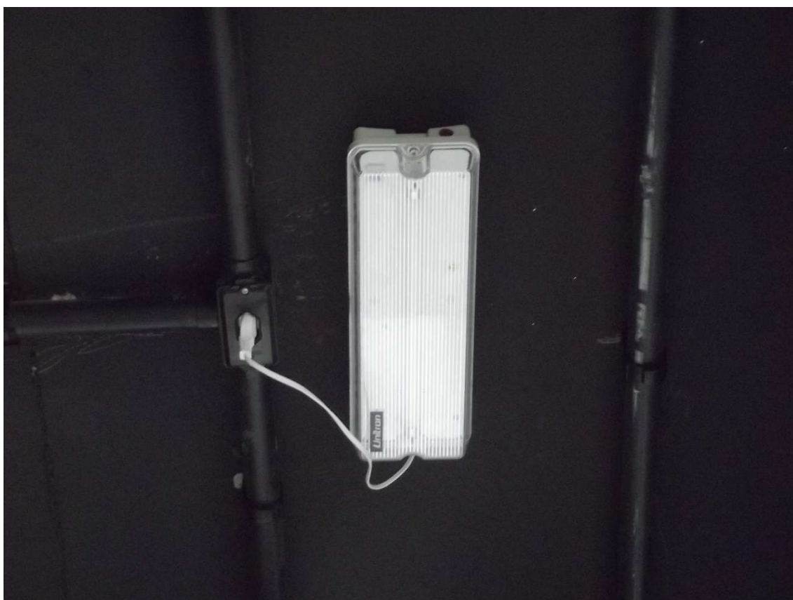
FOTO: Iluminação de emergência
