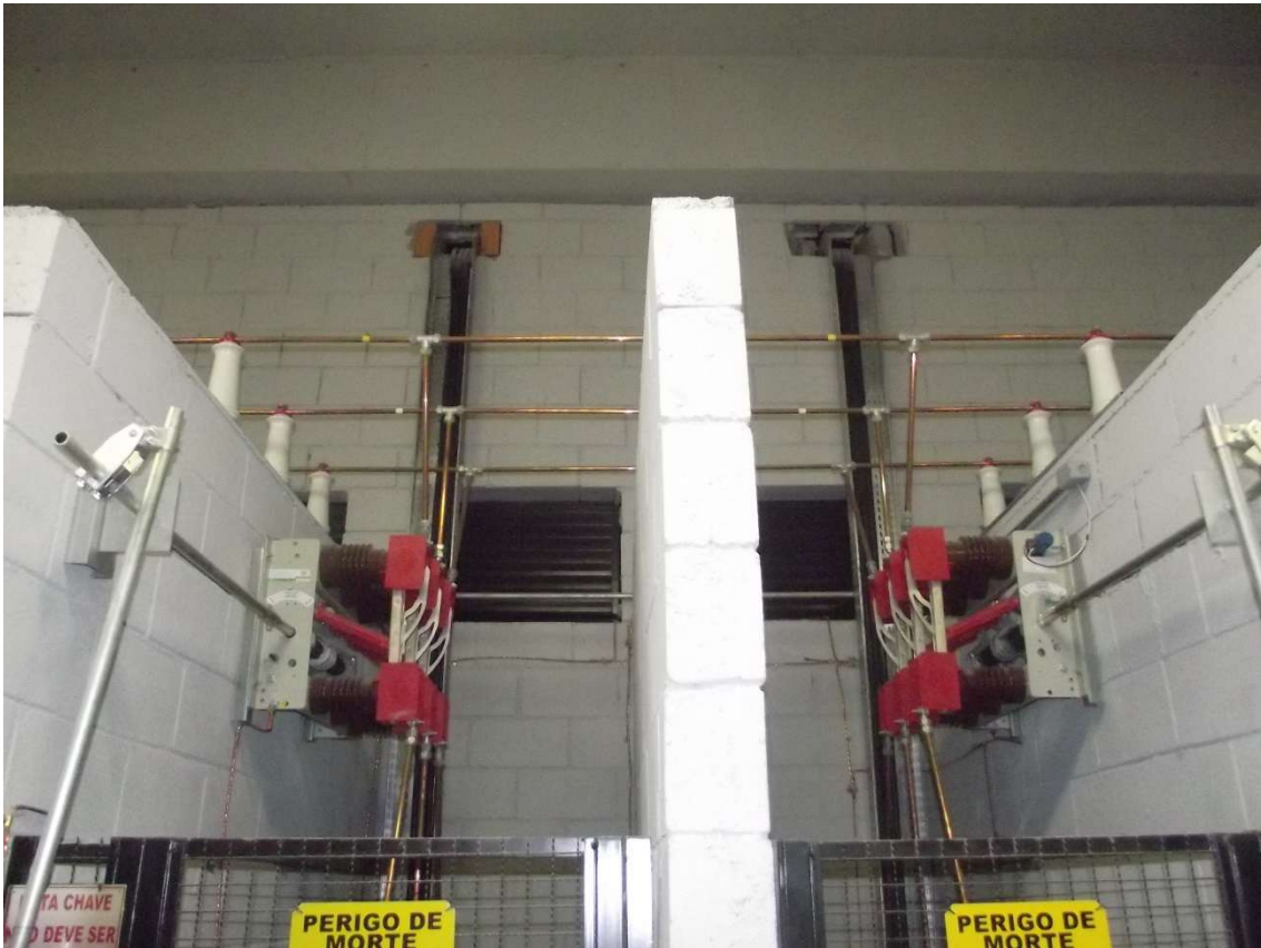
FOTO: Rede de distribuição de média tensão
