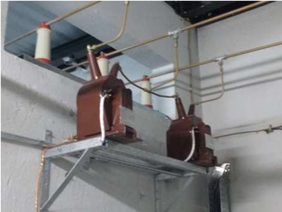
FOTO: Transformador para instrumentos
