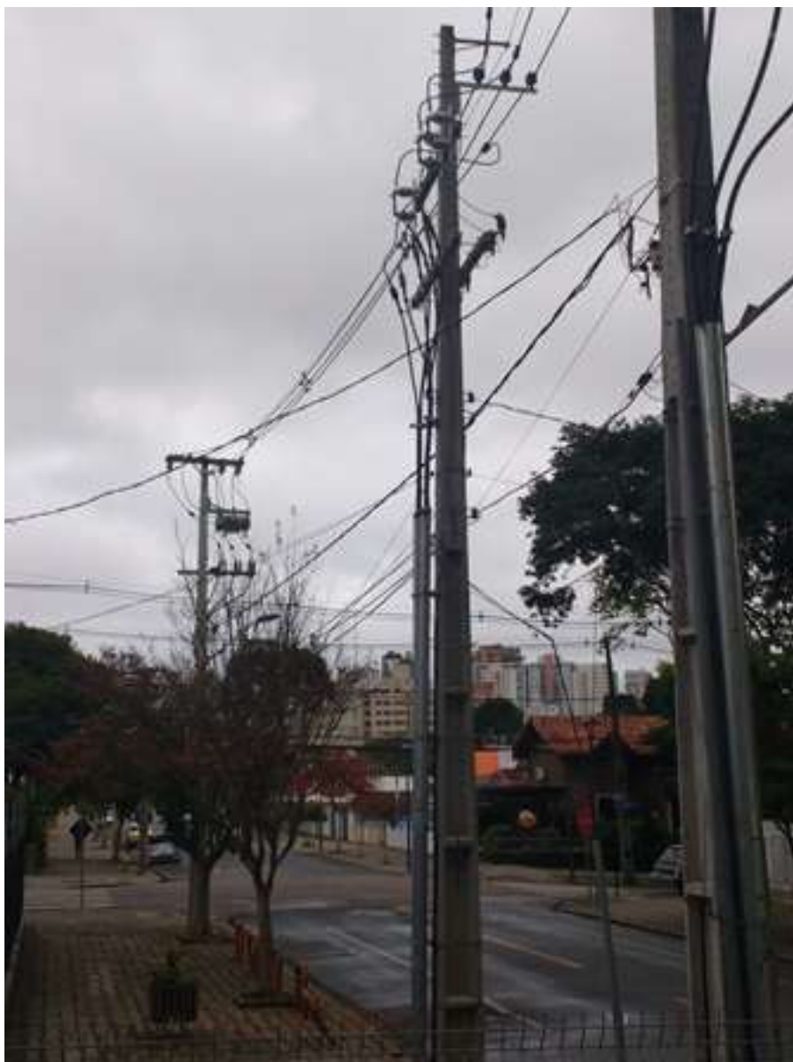
FOTO: Entrada de energia
