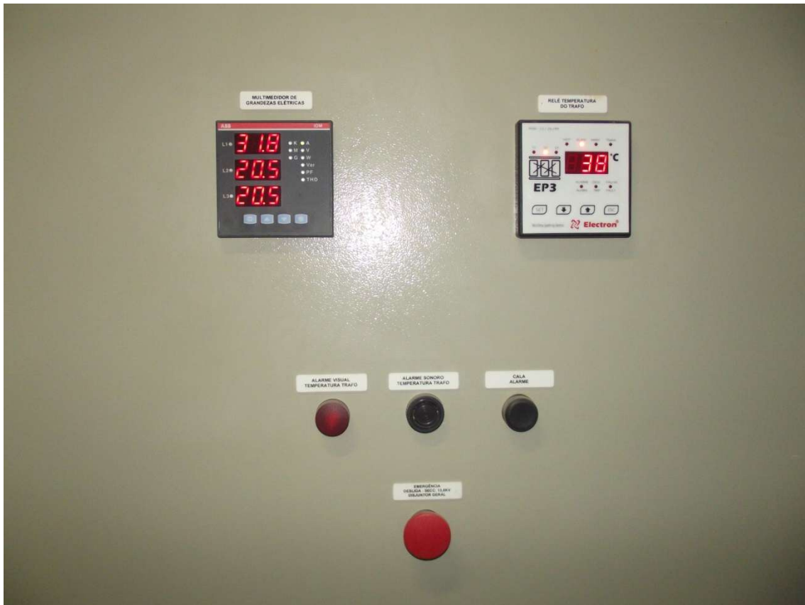
FOTO: Medidores de energia
