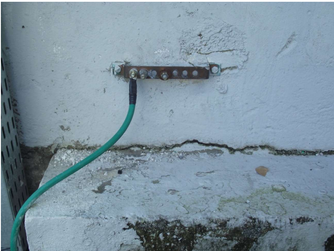
FOTO: Aterramentos sistema de equipotencialização principal
