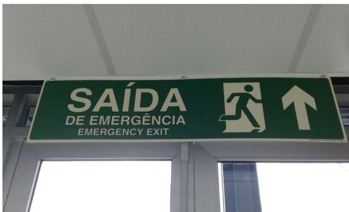
FOTO: Sinalização de emergência
