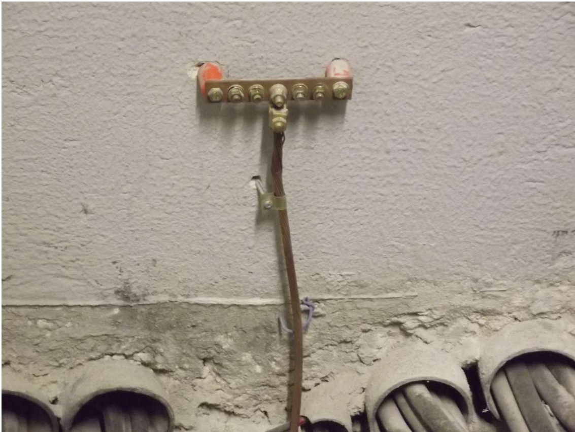
FOTO: Aterramento subestação principal
