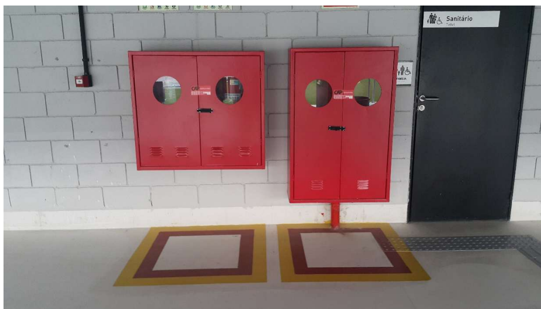
FOTO: Sistemas de combate a incêndio
