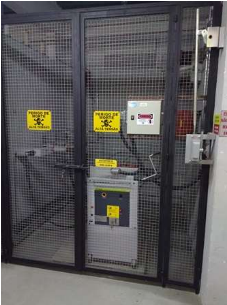
FOTO: Disjuntores de média tensão
