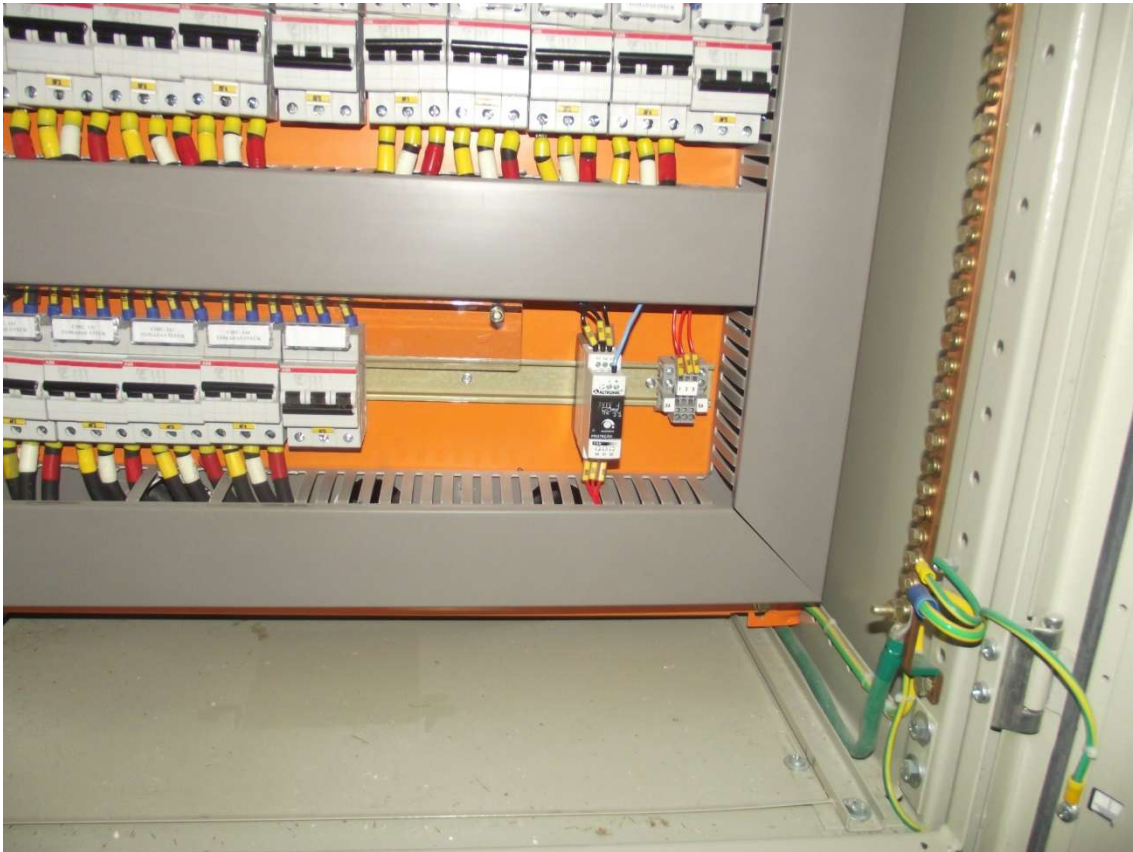
FOTO: Aterramento quadros de distribuição geral BT
