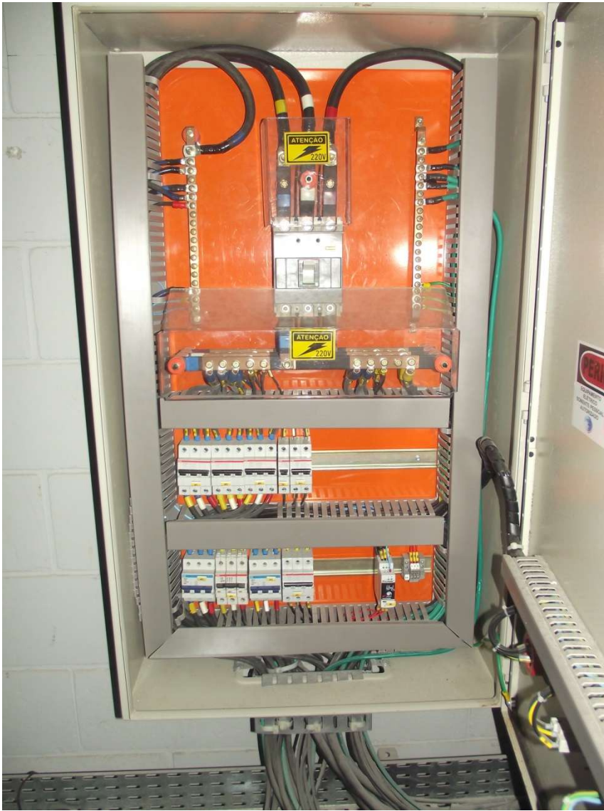
FOTO: Quadro de distribuição
