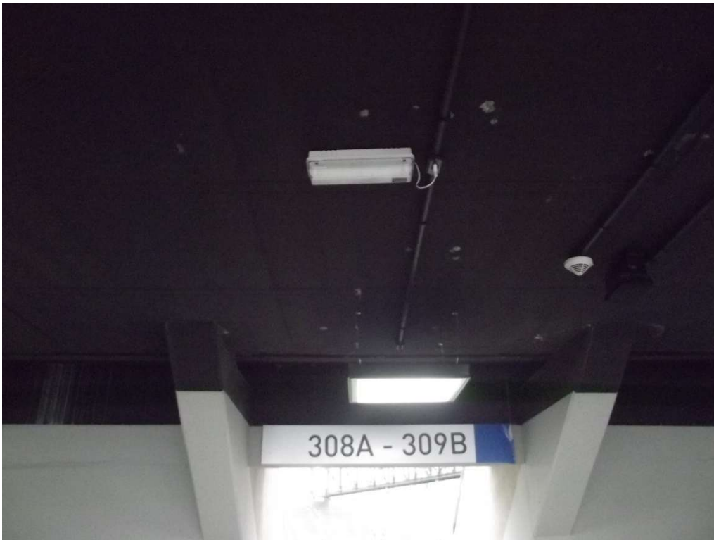
FOTO: Iluminação de emergência
