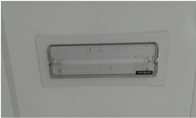
FOTO: Iluminação de emergência
