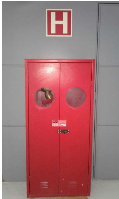
FOTO: Abrigos de hidrantes
