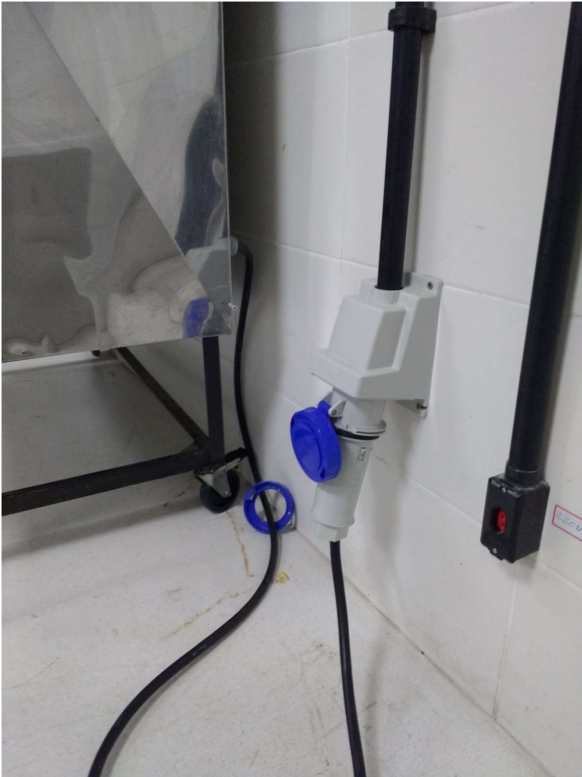
FOTO: Tomadas utilizadas em fornos
