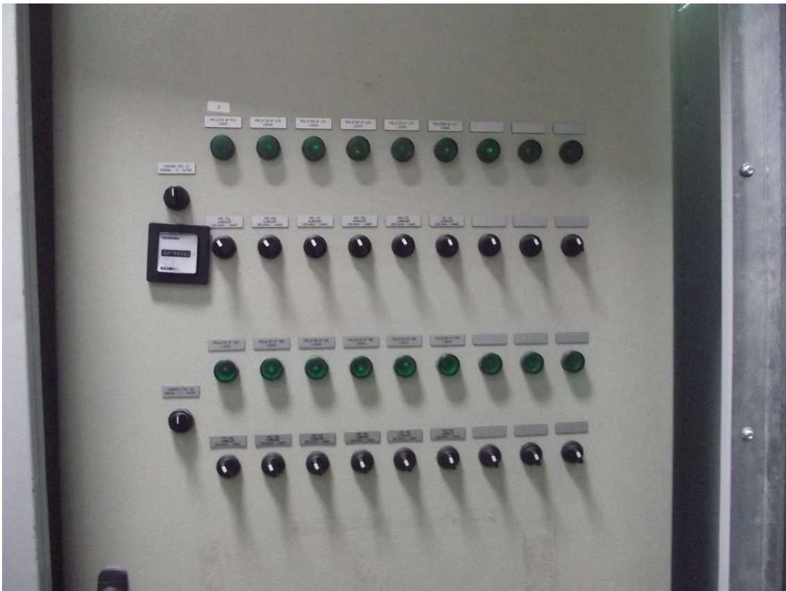
FOTO: Quadro elétrico acionamento iluminação campo
