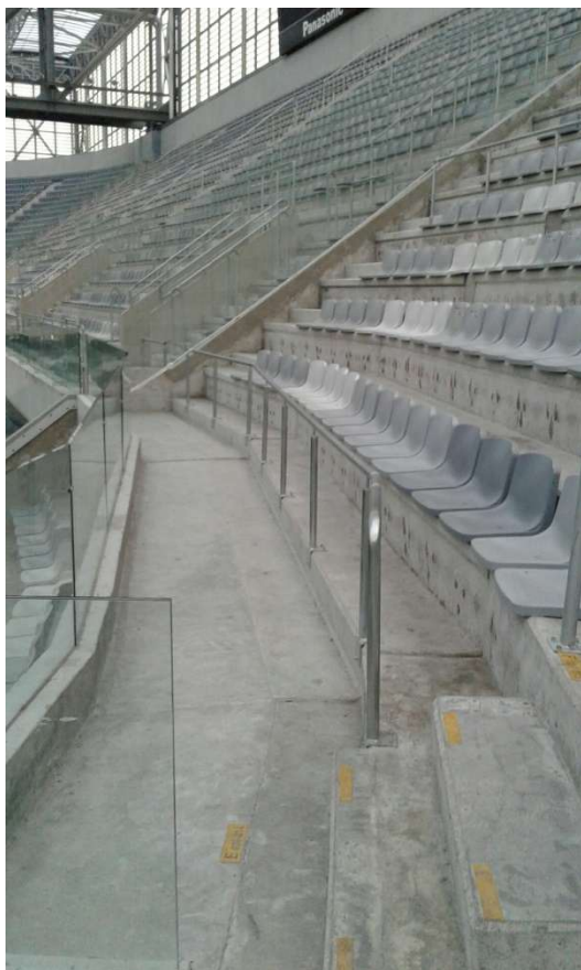
FOTO: Guarda-corpo arquibancada
