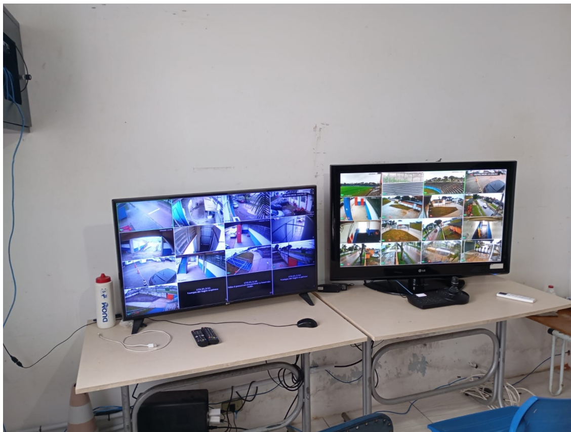
Figura 7 – Central de videomonitoramento
