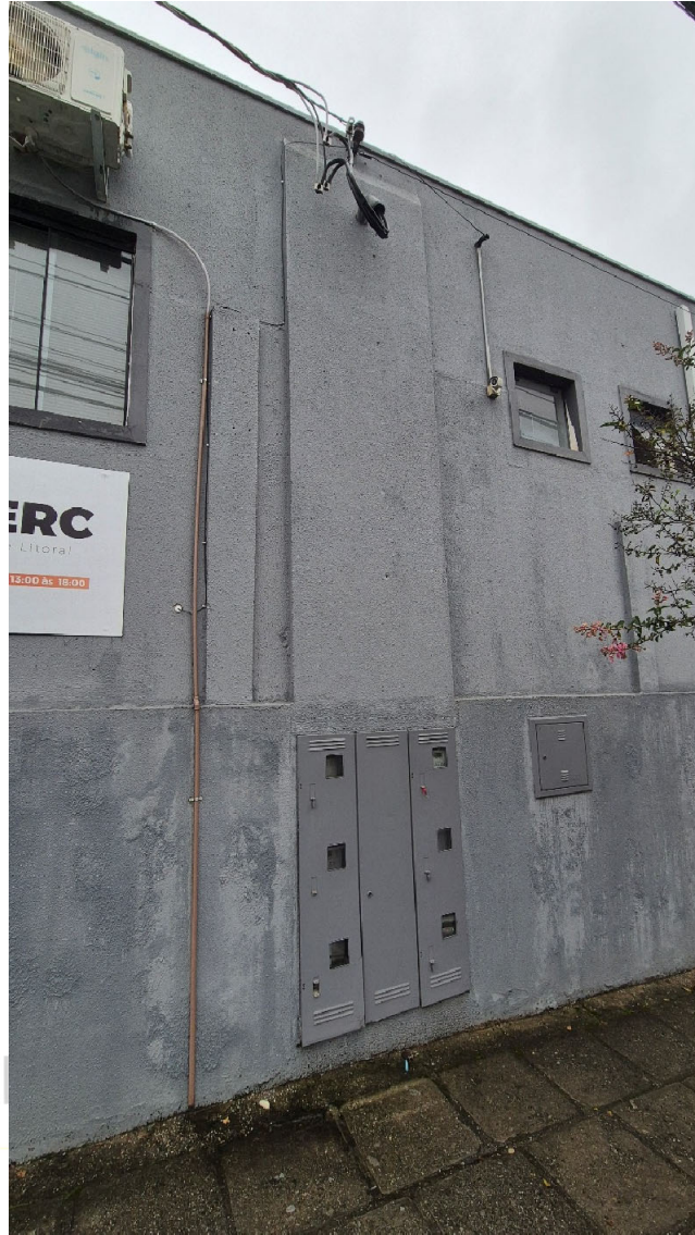
Figura 2 - Entrada de baixa tensão 02
