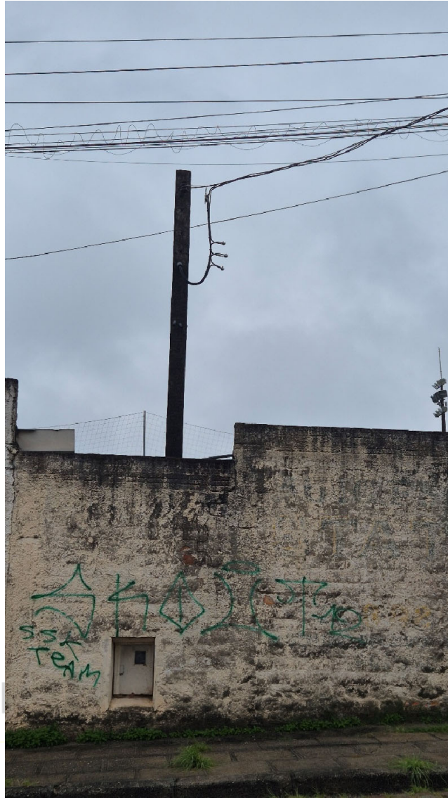
Figura 3 - Entrada de baixa tensão 03
