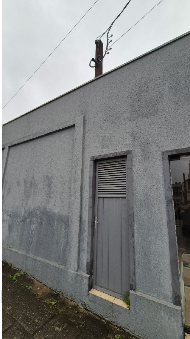
Figura 1 - Entrada de baixa tensão 01
