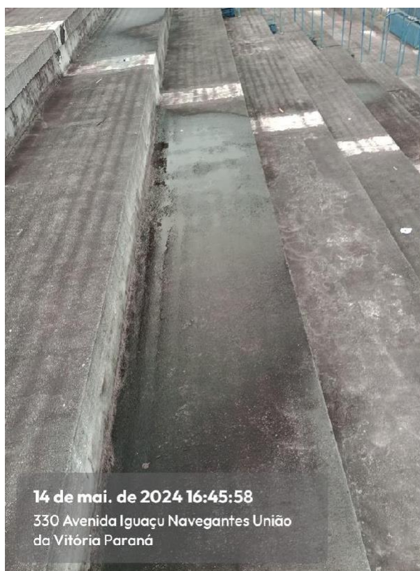
Imagem 56: Infiltração, água empoeada e desgaste excessivo do concreto em lajes no Setor C
