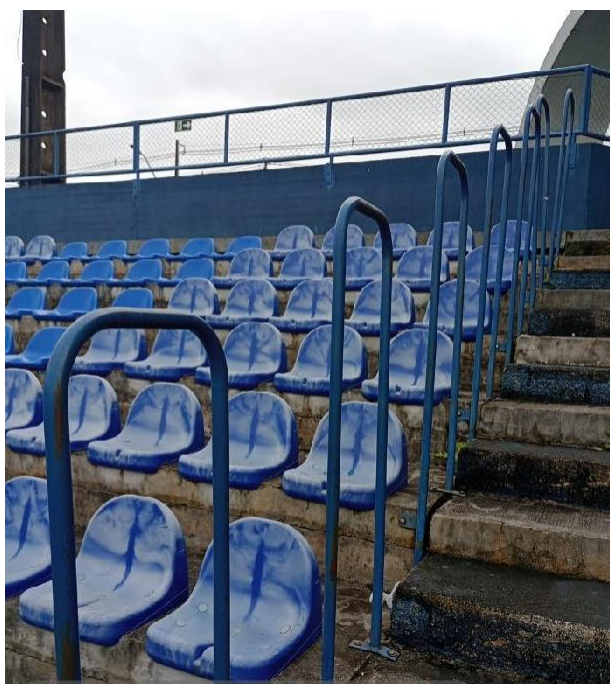
Imagem 29: Infiltração em lajes no Setor B
