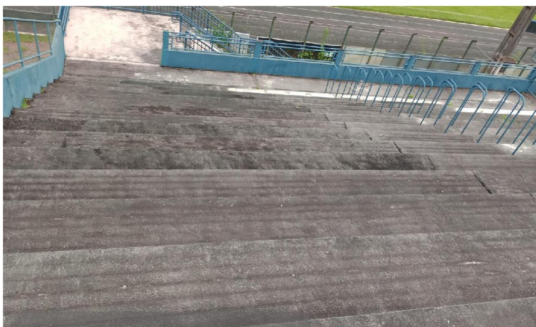
Imagem 82: Infiltração e desgaste excessivo do concreto em lajes e alvenaria no Setor D
