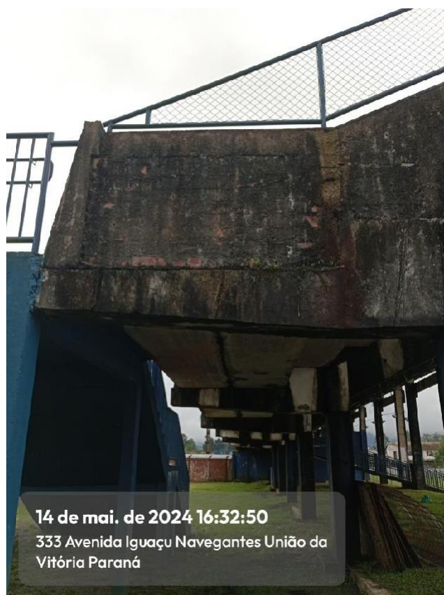
Imagem 60: Infiltração e vegetação intrusiva em vigas, pilares e lajes no Setor D
