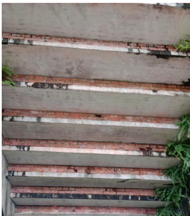
Imagem 34: Infiltração e vegetação intrusiva em lajes no Setor C
