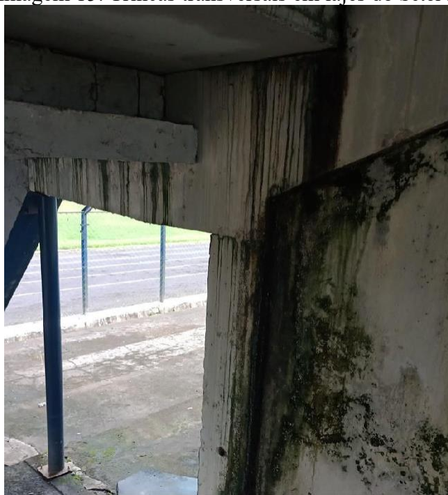
Imagem 16: Infiltração e vegetação intrusiva em pilar e vigas no Setor B
