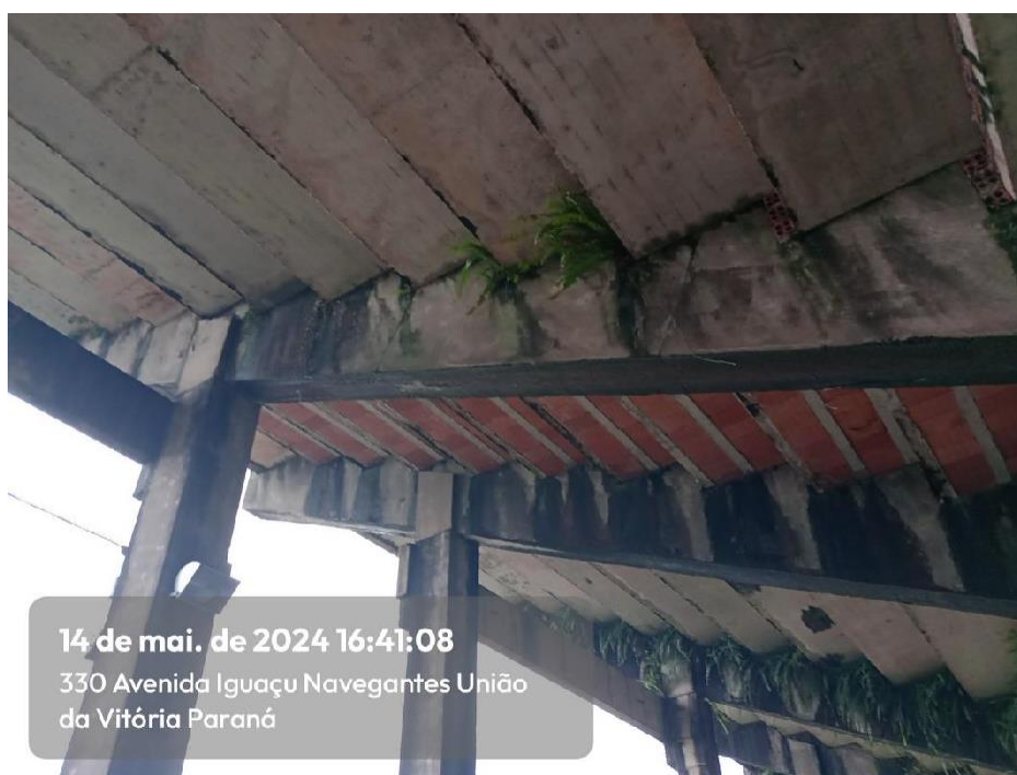
Imagem 37: Infiltração e vegetação intrusiva em lajes, vigas e pilares no Setor C
