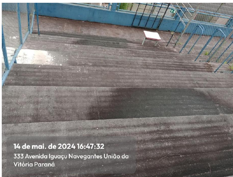
Imagem 59: Infiltração, água empoçada e desgaste excessivo do concreto em lajes no Setor C
