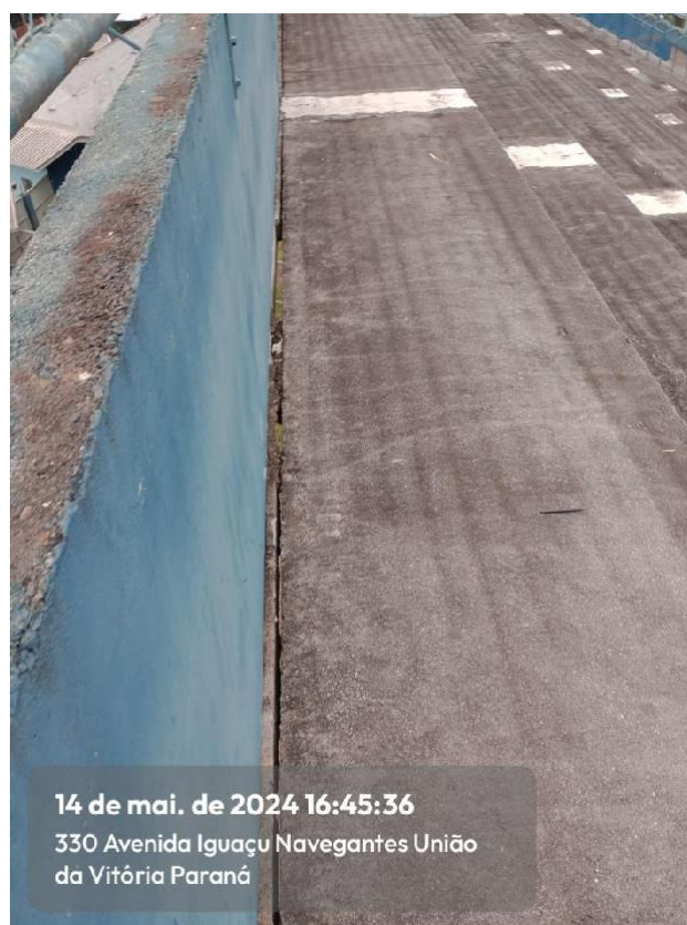
Imagem 54: Infiltração e desgaste excessivo do concreto em lajes no Setor C
