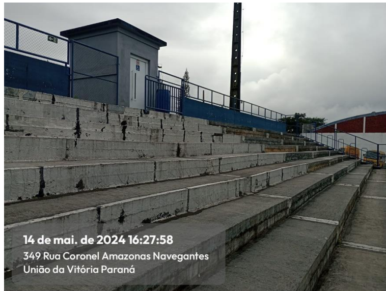
Imagem 83: Fissuras no material impermeabilizante no Setor A
