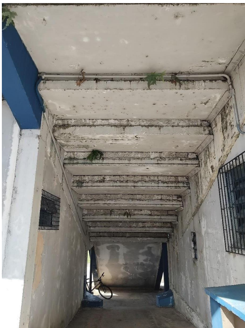
Imagem 04: Infiltração e vegetação intrusiva em lajes no Setor A
