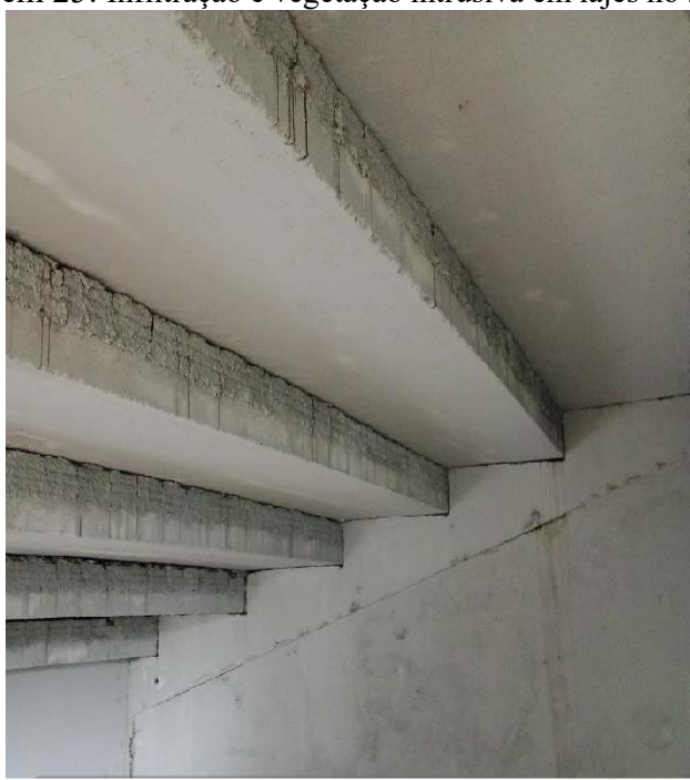
Imagem 26: Infiltração em lajes no Setor B
