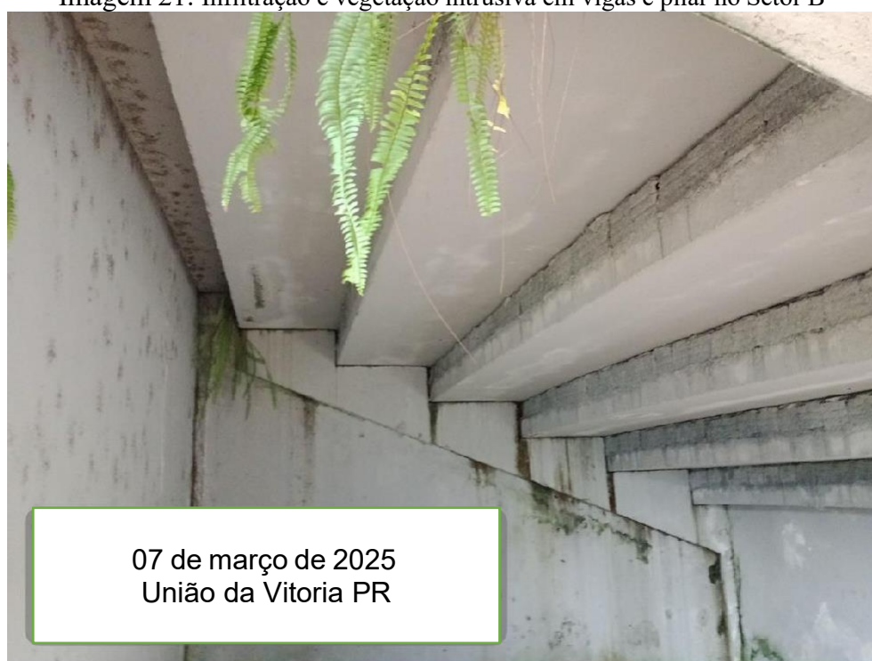
Imagem 22: Infiltração e vegetação intrusiva em vigas e lajes no Setor B
