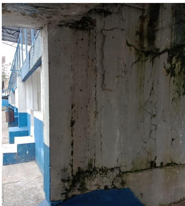
Imagem 08: Infiltração e vegetação intrusiva em viga e pilar no Setor A
