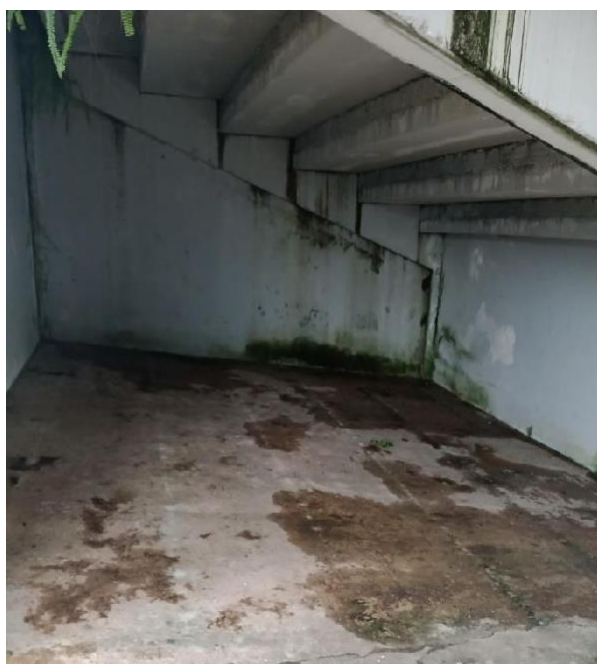
Imagem 21: Infiltração e vegetação intrusiva em vigas e pilar no Setor B
