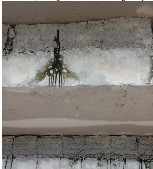
Imagem 24: Infiltração e vegetação intrusiva em lajes, com presença de estalactite no Setor B
