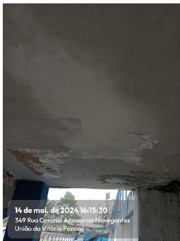
Imagem 09: Infiltração e vegetação intrusiva em laje e pilar no Setor A
