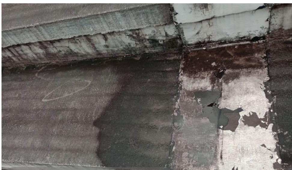
Imagem 88: Fissuras no material impermeabilizante no Setor C
