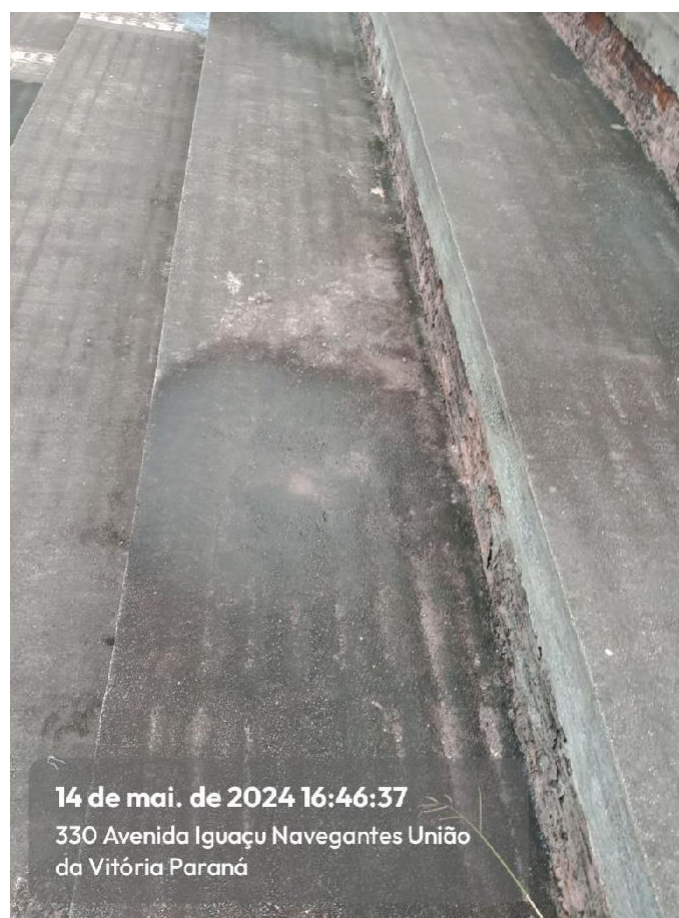
Imagem 58: Infiltração, água empoçada e desgaste excessivo do concreto em lajes no Setor C
