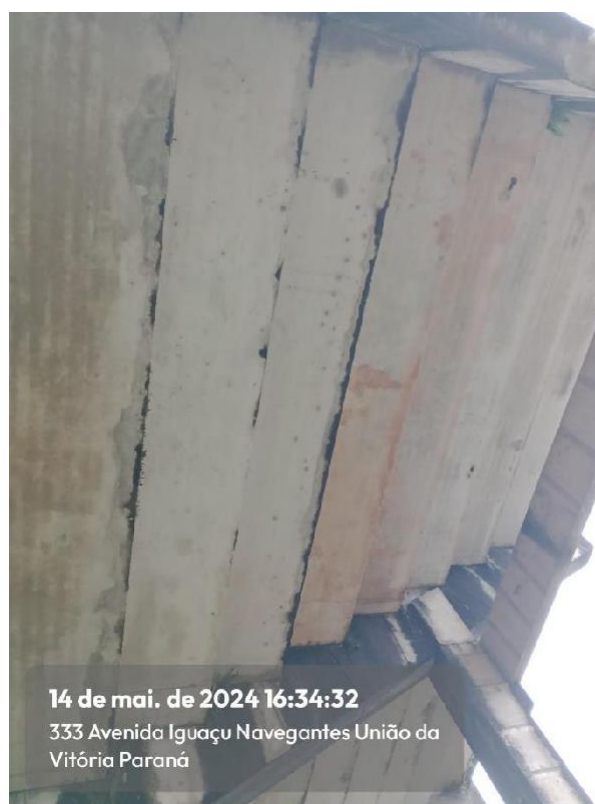
Imagem 65: Infiltração e vegetação intrusiva em vigas e lajes no Setor D
