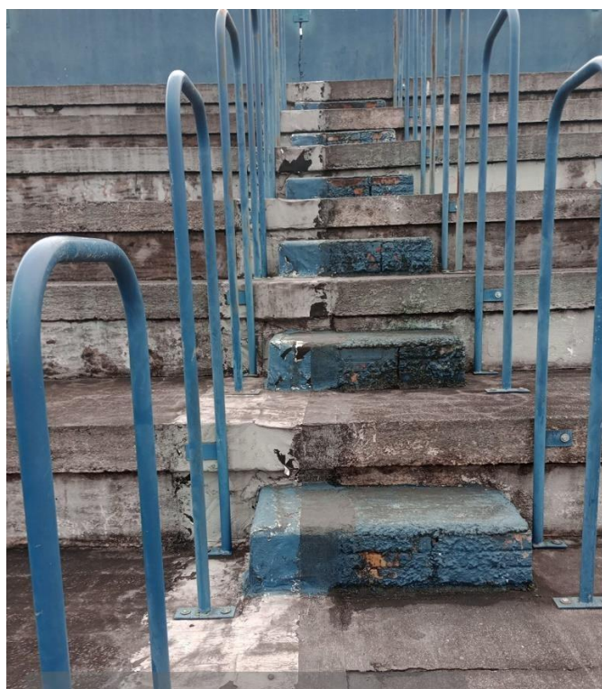
Imagem 87: Fissuras no material impermeabilizante no Setor C
