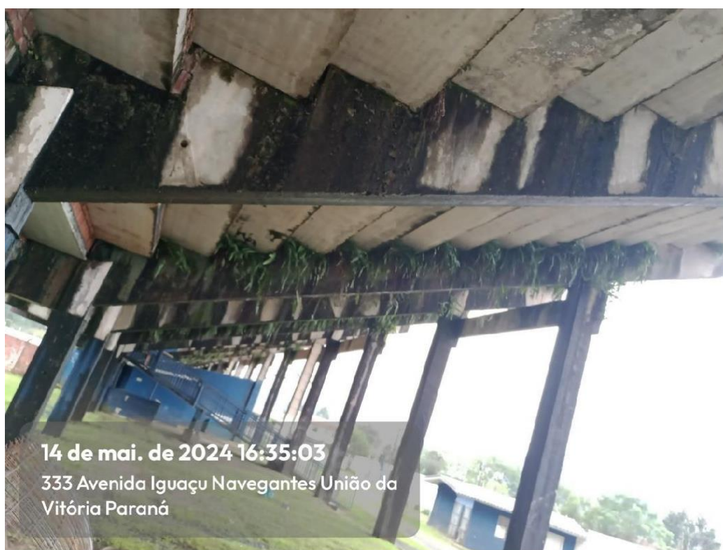
Imagem 67: Infiltração e vegetação intrusiva em vigas, pilares e lajes no Setor D
