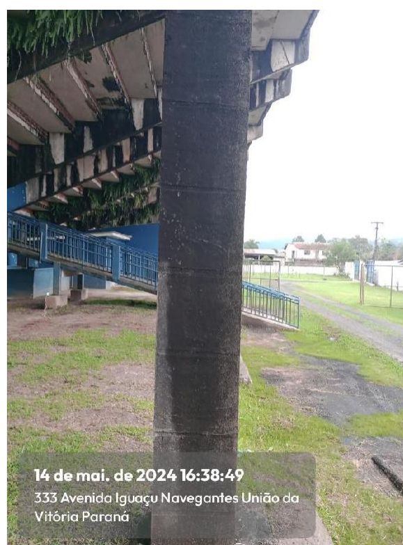
Imagem 76: Infiltração e vegetação intrusiva em vigas, pilares e lajes no Setor D
