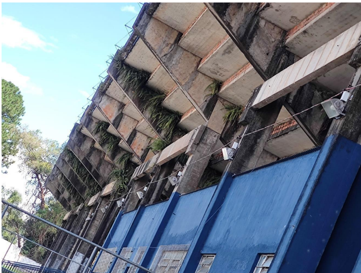
Imagem 38: Infiltração e vegetação intrusiva em lajes e vigas no Setor C
