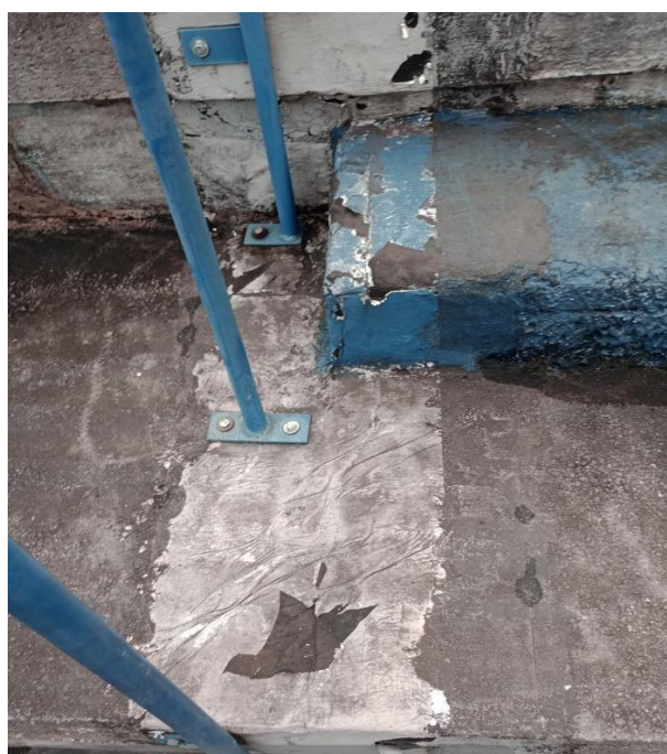
Imagem 86: Fissuras no material impermeabilizante no Setor C
