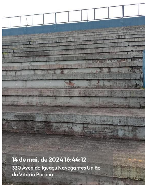
Imagem 48: Infiltração e trincas em lajes e alvenaria no Setor C
