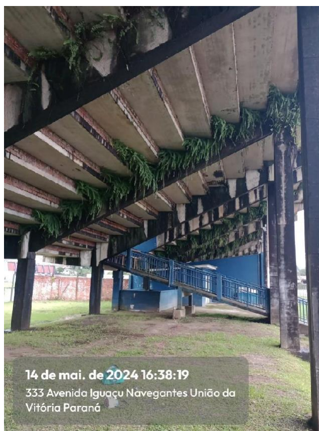
Imagem 75: Infiltração e vegetação intrusiva em vigas, pilares e lajes no Setor D
