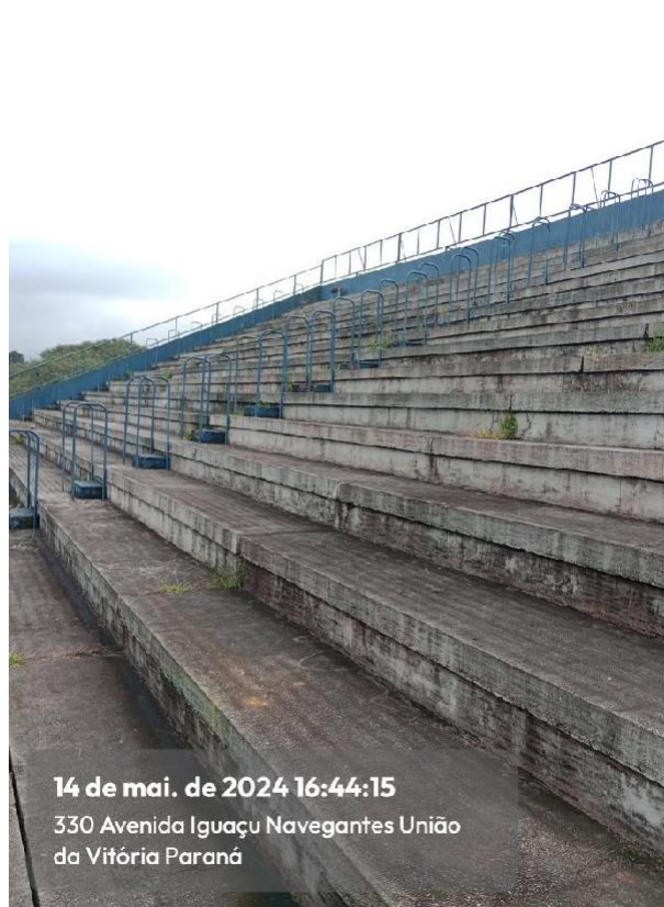
Imagem 49: Infiltração, trincas e vegetação intrusiva em lajes e alvenaria no Setor C
