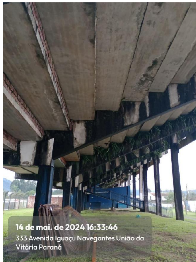
Imagem 62: Infiltração e vegetação intrusiva em vigas, pilares e lajes no Setor D
