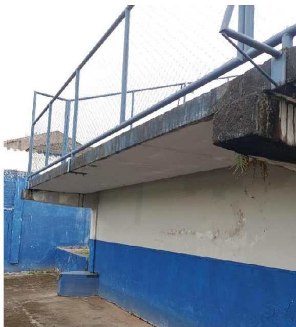
Imagem 27: Infiltração em lajes e vigas no Setor B
