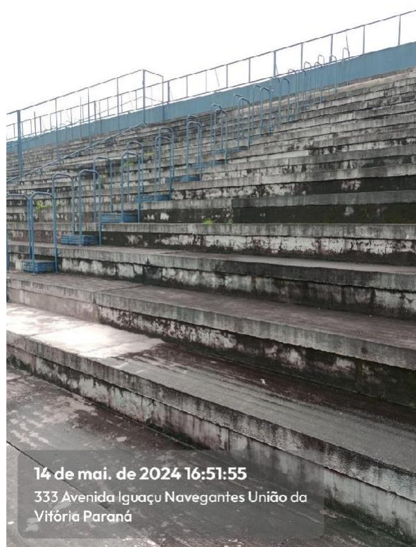
Imagem 78: Infiltração e água empoçada e desgaste excessivo do concreto em lajes e alvenaria no Setor D
