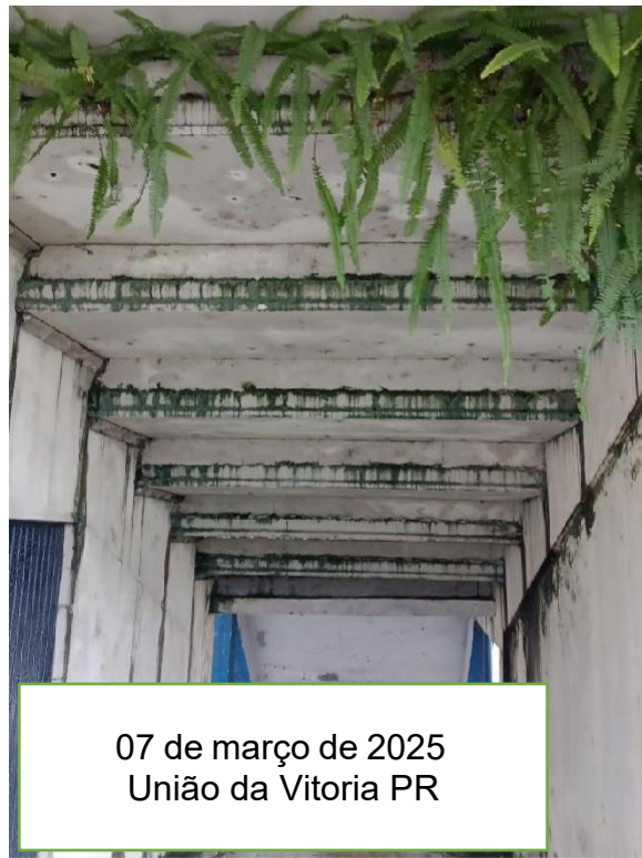
Imagem 17: Infiltração e vegetação intrusiva em vigas e lajes no Setor B
