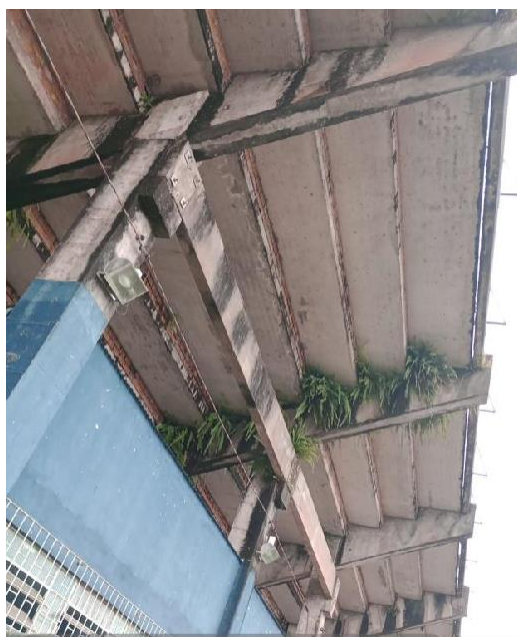
Imagem 39: Infiltração e vegetação intrusiva em lajes, pilares e vigas no Setor C
