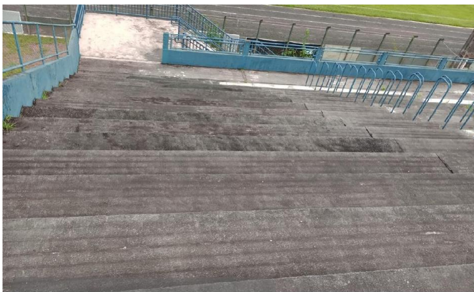
Imagem 80: Infiltração e água empoçada e desgaste excessivo do concreto em lajes e alvenaria no Setor D
