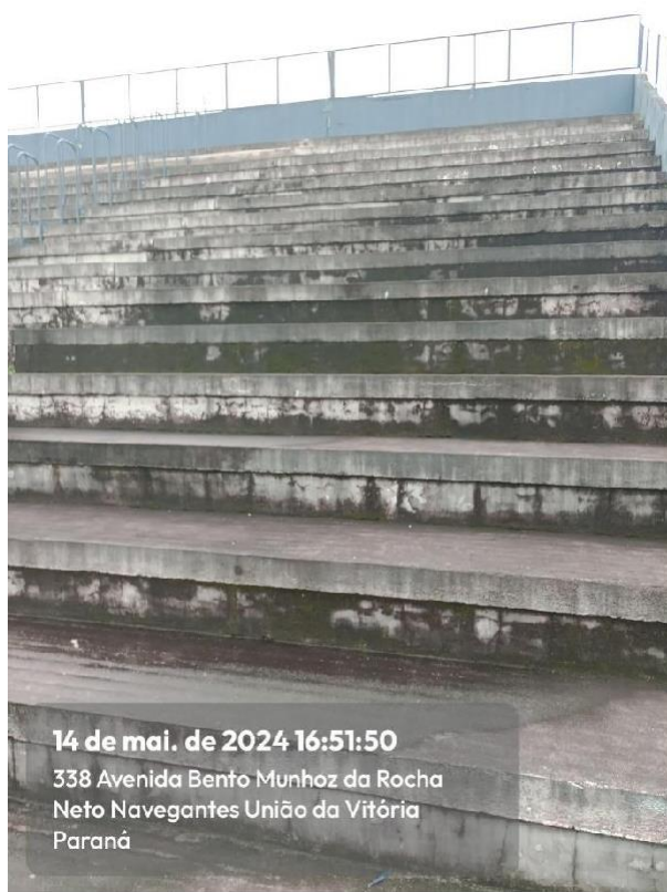
Imagem 77: Infiltração e água empoçada em lajes e alvenaria no Setor D
