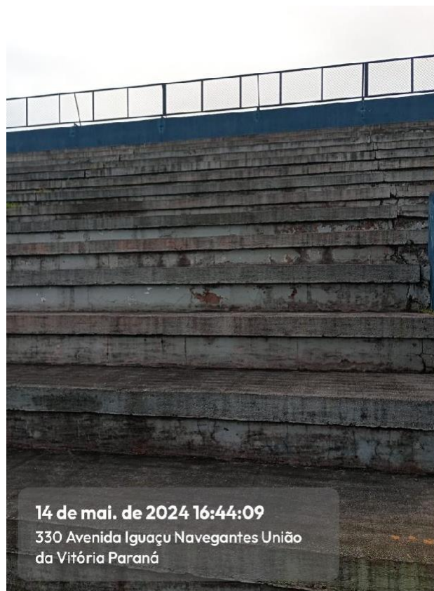
Imagem 47: Infiltração e trincas em lajes e alvenaria no Setor C
