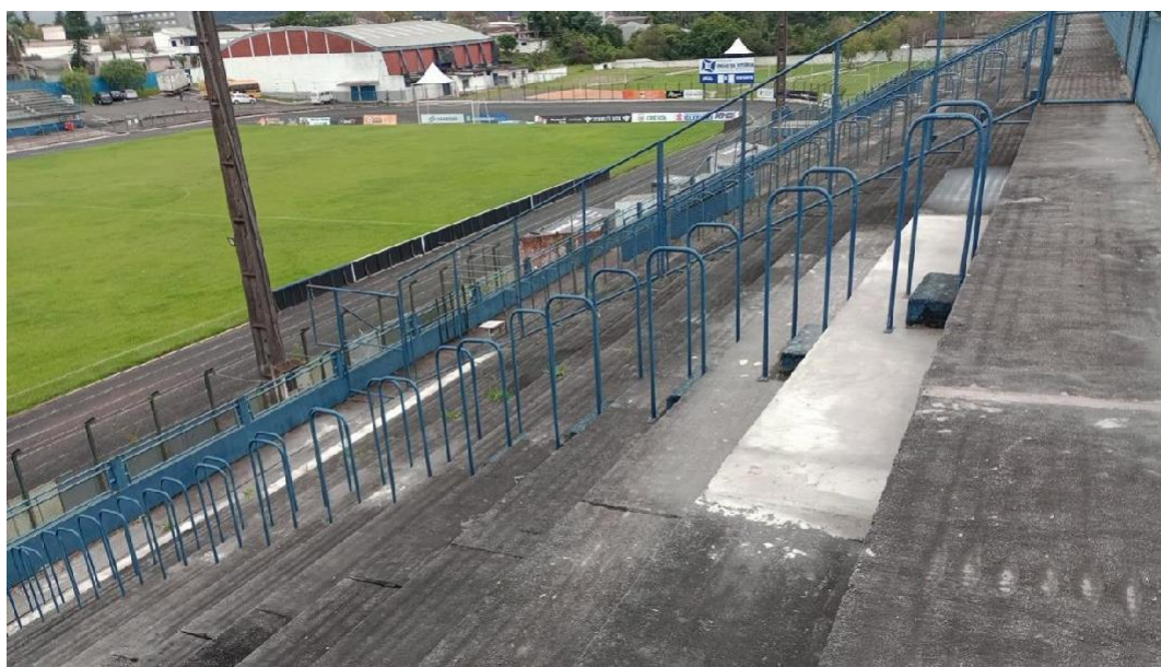
Imagem 81: Infiltração e desgaste excessivo do concreto em lajes e alvenaria no Setor D
