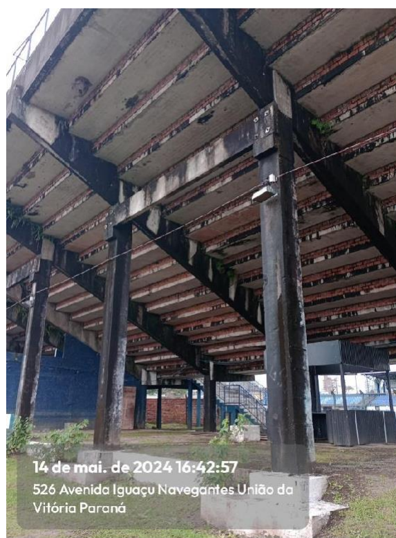
Imagem 44: Infiltração e vegetação intrusiva em lajes, vigas e pilares no Setor C
