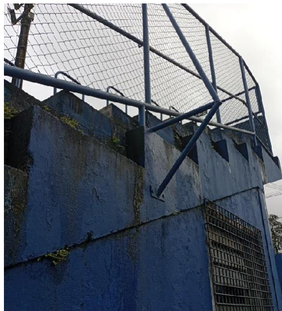
Imagem 03: Infiltração e vegetação intrusiva em lajes, pilar e alvenaria no Setor A
