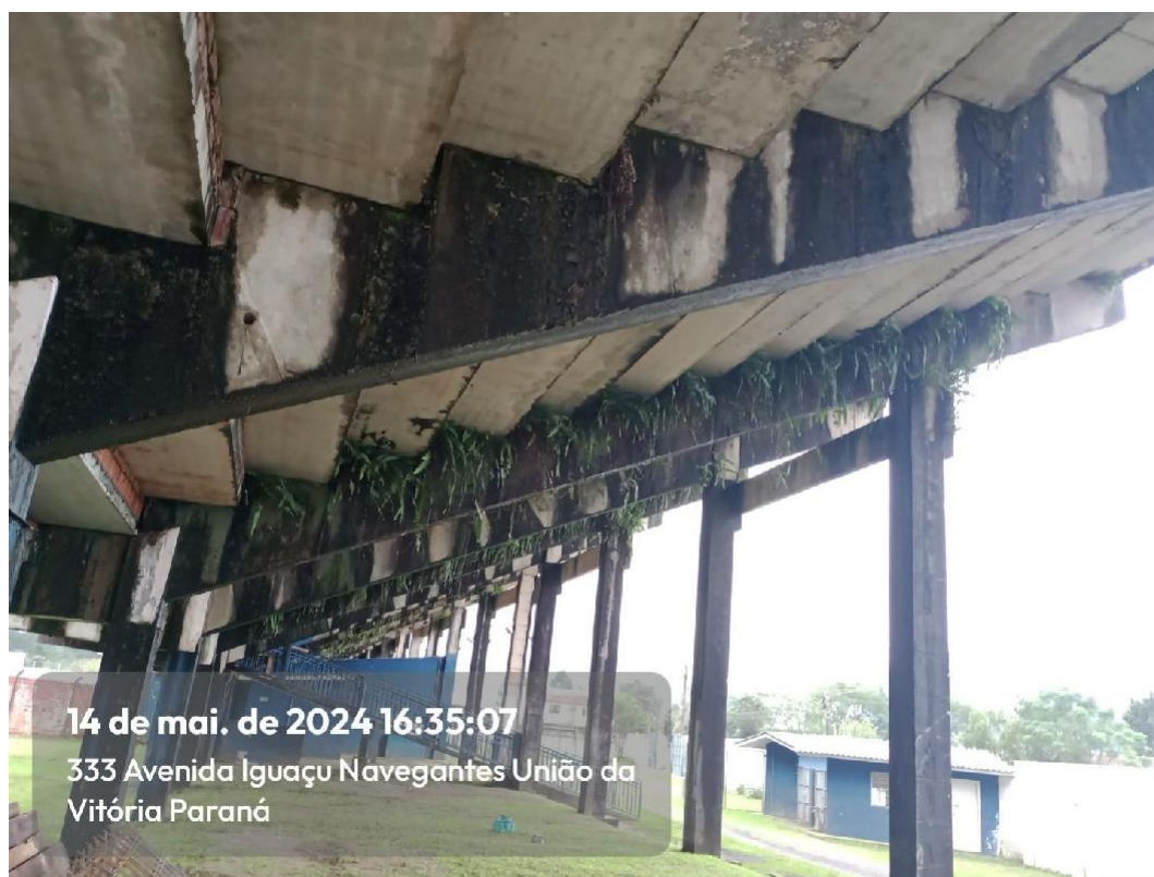
Imagem 68: Infiltração e vegetação intrusiva em vigas, pilares e lajes no Setor D
