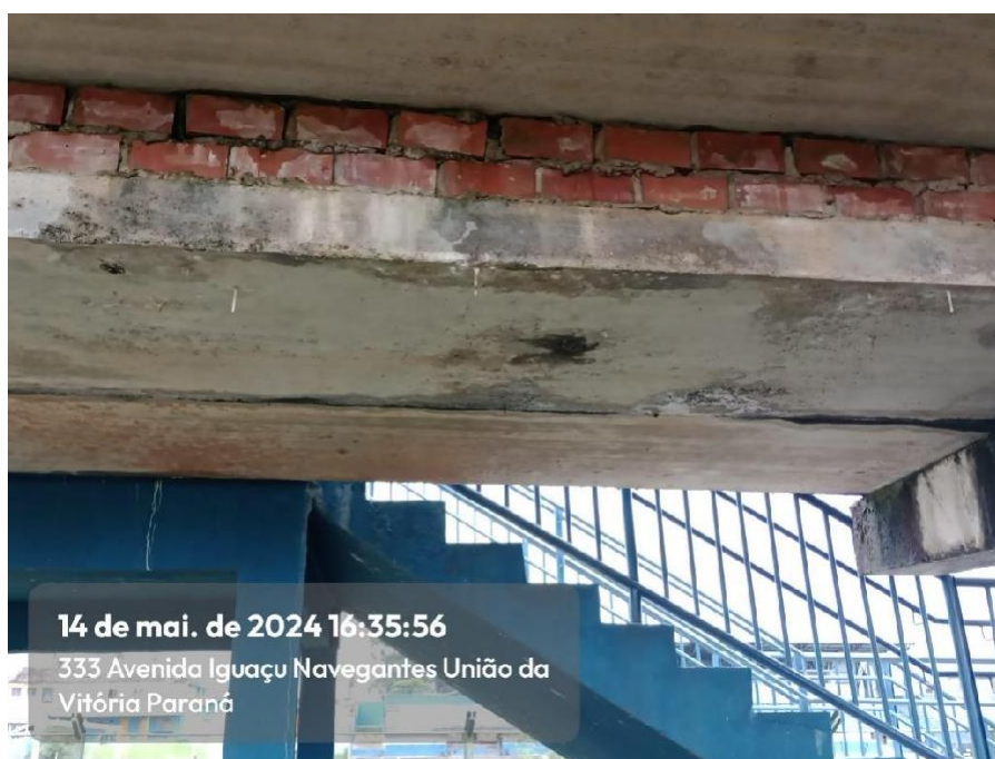
Imagem 71: Infiltração em vigas e lajes, com presença de estalactites no Setor D
