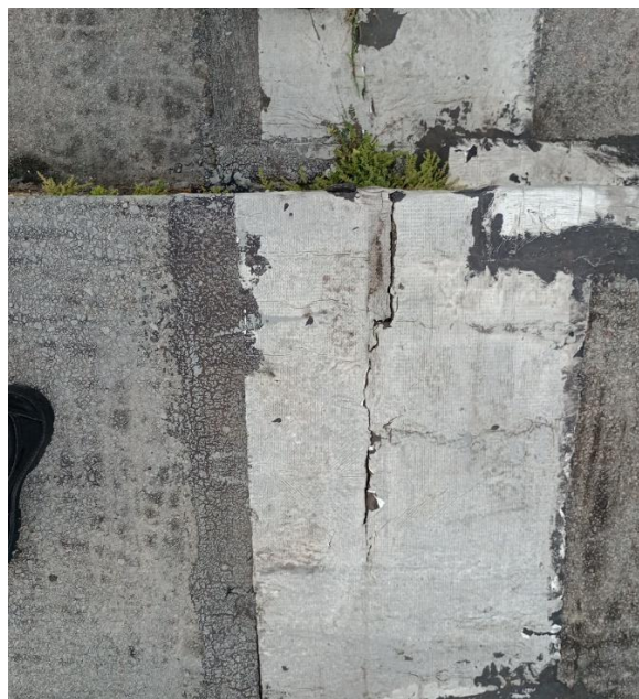
Imagem 84: Fissuras no material impermeabilizante no Setor A
