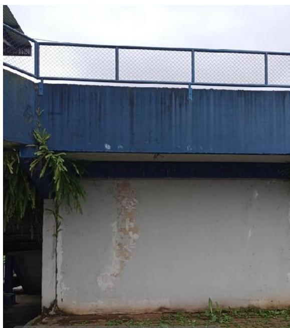
Imagem 19: Infiltração e vegetação intrusiva em vigas, lajes e alvenaria no Setor B
