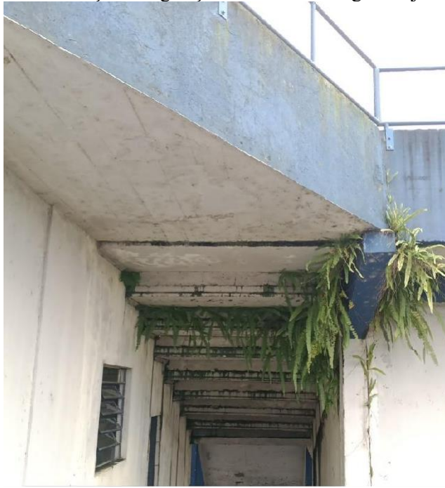
Imagem 18: Infiltração e vegetação intrusiva em vigas e lajes no Setor B
