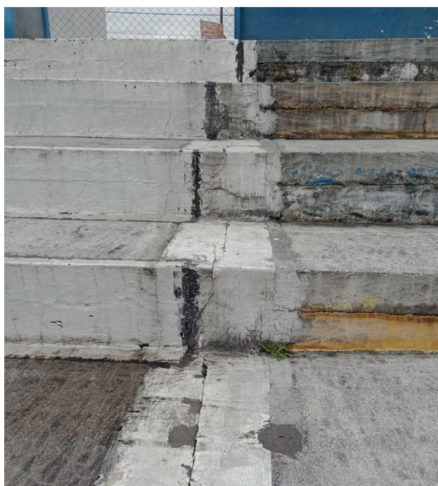
Imagem 85: Fissuras no material impermeabilizante no Setor C
