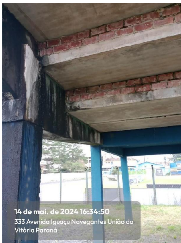
Imagem 66: Infiltração e vegetação intrusiva em vigas e lajes no Setor D
