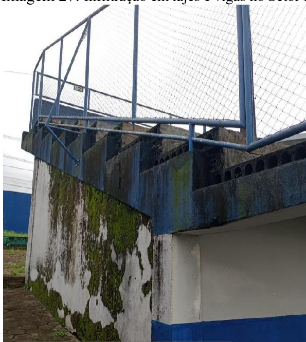
Imagem 28: Infiltração e vegetação intrusiva em alvenaria e vigas no Setor B
