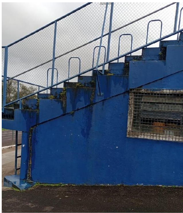
Imagem 01: Infiltração e vegetação intrusiva em lajes, pilar e alvenaria no Setor A
