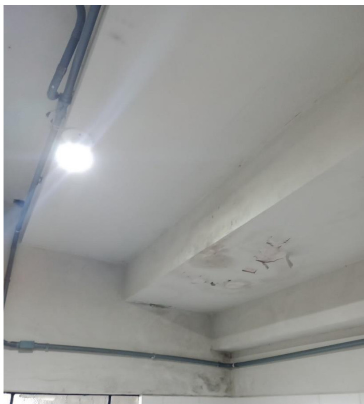
Imagem 32: Infiltração em lajes no Setor Cadeiras
