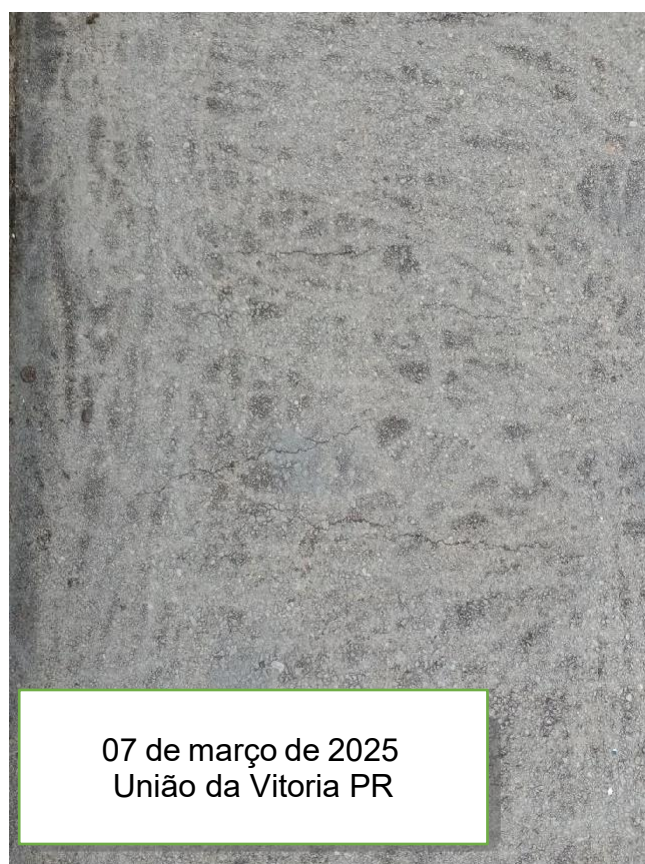
Imagem 15: Trincas transversais em lajes do Setor A
