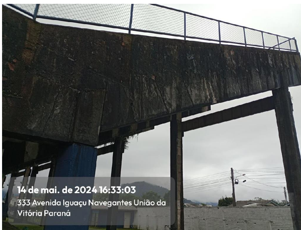
Imagem 61: Infiltração e vegetação intrusiva em vigas, pilares e lajes no Setor D
