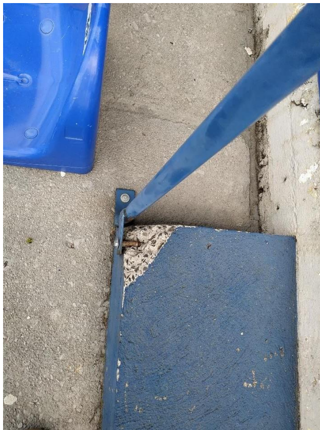
Imagem 91: Falha no chumbamento do guarda-corpo no Setor B
