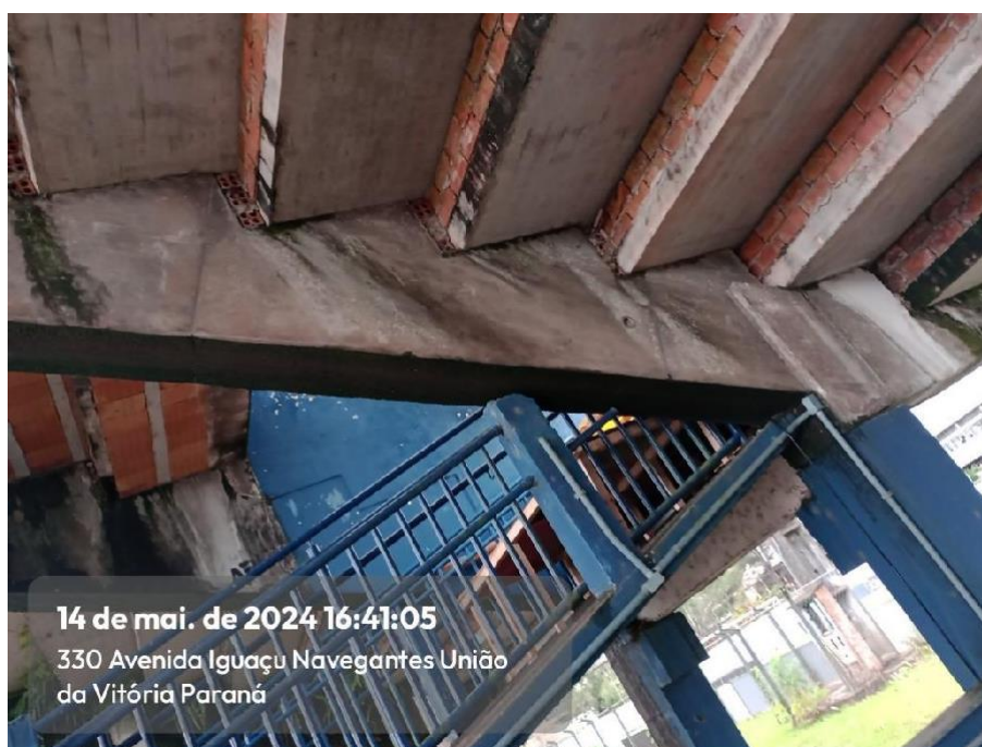
Imagem 36: Infiltração e vegetação intrusiva em lajes e vigas no Setor C
