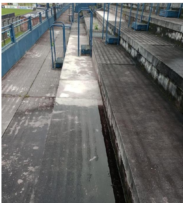
Imagem 79: Infiltração e água empoçada e desgaste excessivo do concreto em lajes e alvenaria no Setor D
