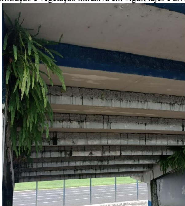
Imagem 20: Infiltração e vegetação intrusiva em vigas e lajes no Setor B
