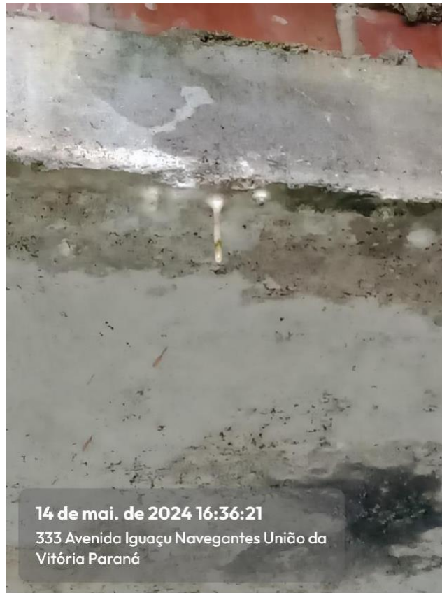
Imagem 73: Infiltração em lajes, com presença de estalactite no Setor D
