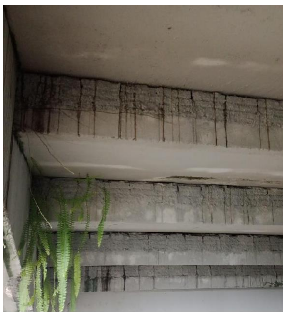
Imagem 25: Infiltração e vegetação intrusiva em lajes no Setor B
