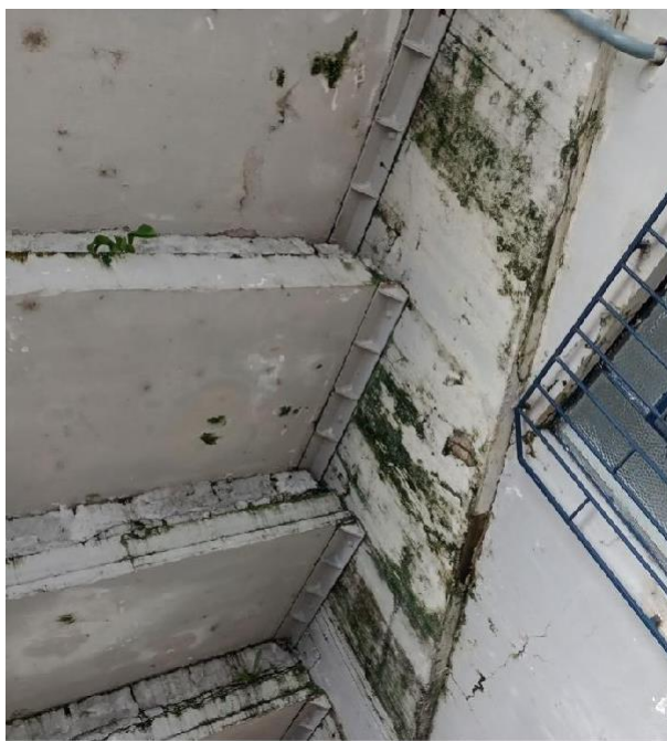
Imagem 13: Infiltração e vegetação intrusiva em lajes e viga no Setor A
