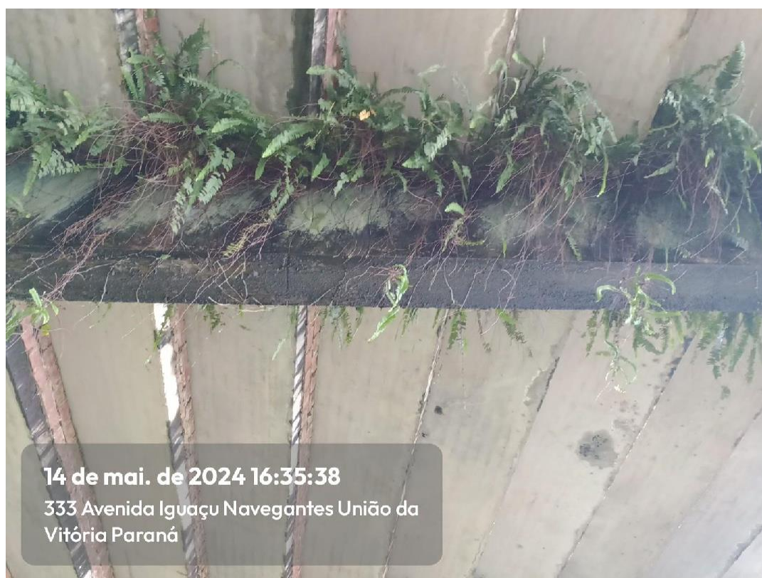
Imagem 70: Infiltração e vegetação intrusiva em vigas, pilares e lajes no Setor D
